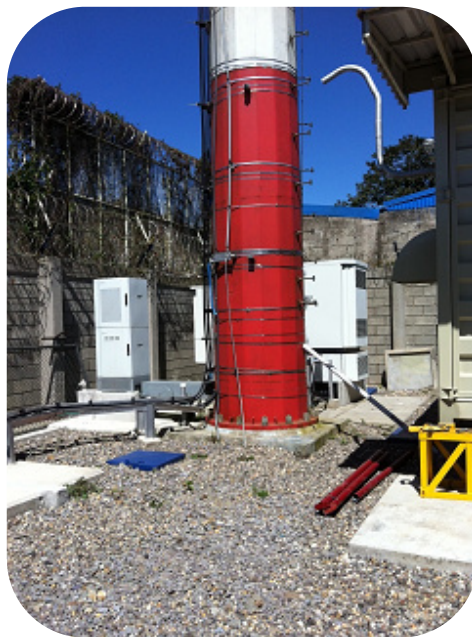
Figura 37. Cama de piedra de una radio base.
