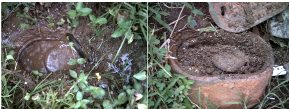
Figuras A.7.96 y A.7.97. Agua y tierra que obstaculizan la lectura de los medidores.
