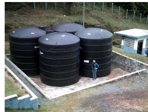
Figura A.7.56. Nuevos tanques de almacenamiento.
