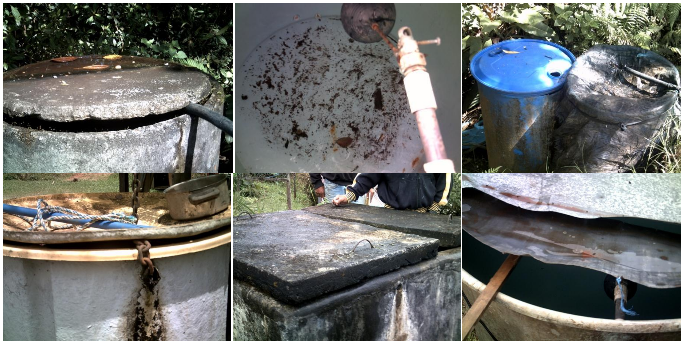
Figuras A.7.66 a A.7.71. Tanques de almacenamiento de agua domiciliar en condiciones no sanitarias.
