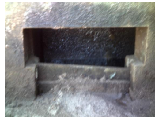
Figura A.7.34. Solera a la entrada de los FLA.
