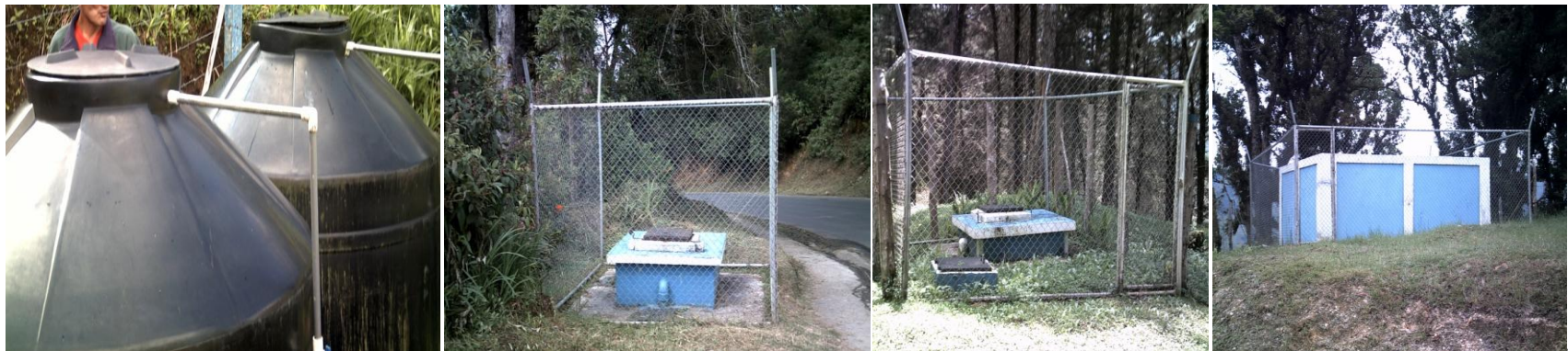
Figuras A.7.48 a A.7.51. Tanques de almacenamiento a lo largo del sistema de distribución.
