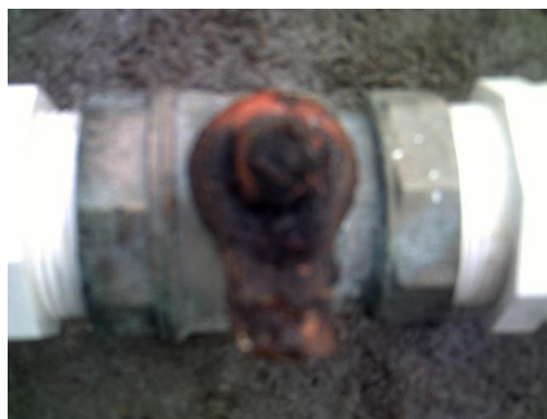
Figura A.7.94. Llave de paso corroída.
