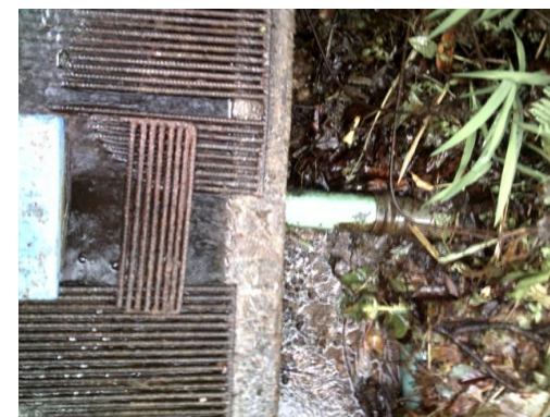
Figura A.7.16. Rejillas y tubería de salida de los desarenadores.
