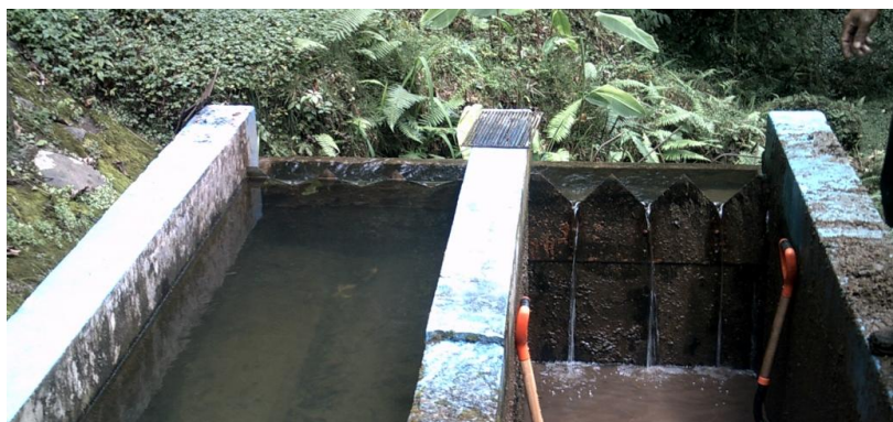
Figura A.7.15. Zona de salida de los desarenadores.
