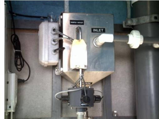
Figura A.7.23. Lector automático de turbiedad alimentado por el efluente del sifón.
