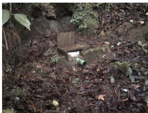
Figura A.7.4. Entrada a la captación de la naciente.
