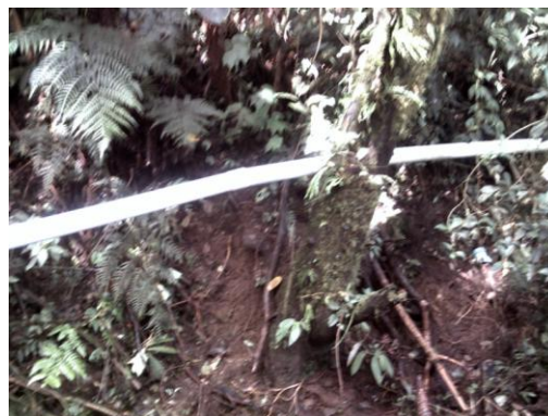
Figura A.7.18. Tubería de conducción.
