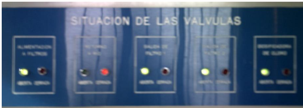
Figura A.7.27. Panel de control del estado o situación de las válvulas automáticas del sistema.
