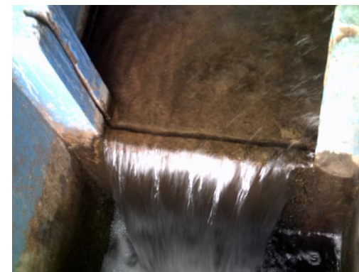
Figura A.7.31. Entrada caudal a la FLA.
