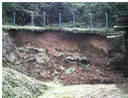
Figura A.7.103. Desprendimiento de taludes en la planta potabilizadora.
