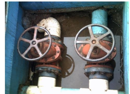
Figura A.7.28. Válvulas manuales.
