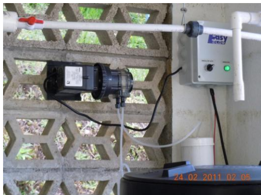
Figura A.7.63. Bomba dosificadora de cloro.
