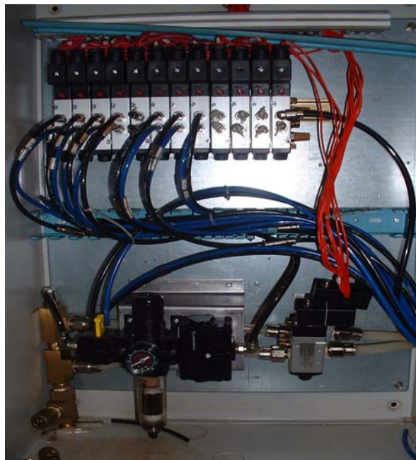
Foto del sistema neumático (Bomba, válvulas, etc)
