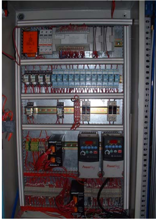
Foto del sistema de control (PLC, relays, etc)
