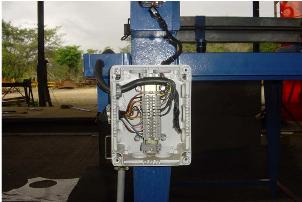
Figura 6.6 Detalle del cableado de la máquina
