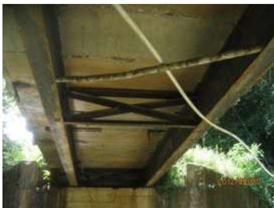
Figura 3. Estado actual de Losetas en la parte inferior
