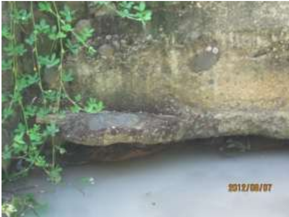
Figura 7. Efecto del agua en la cimentación
