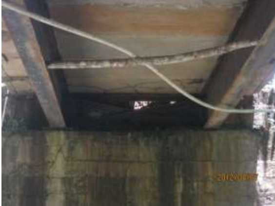
Figura 5 Oxidación en Vigas. Apoyo de Losa en el bastión de ingreso
