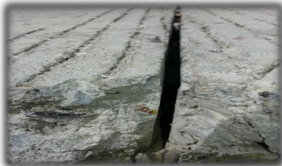
Imagen 27. Junta transversal con deficiencia en el sellado.
