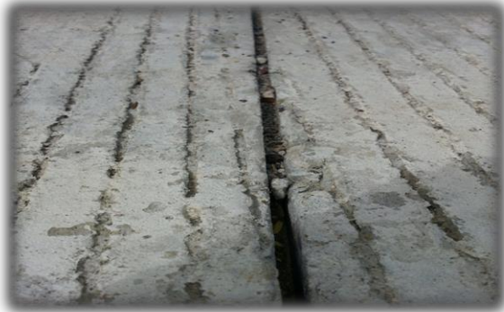
Imagen 26. Junta transversal con falta de material sellador.
