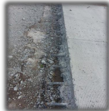
Imagen 25. Canastas de dovelas expuestas por losa defectuosa demolida.
