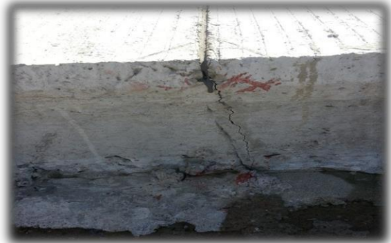
Imagen 23. Agrietamiento de la losa a lo largo del aserrado transversal.
