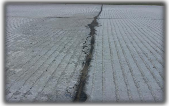
Imagen 28. Despostillamiento en junta transversal.
