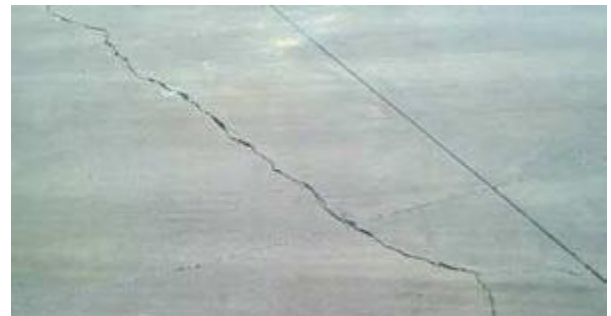
Imagen 21. Ejemplo de fisura longitudinal.
