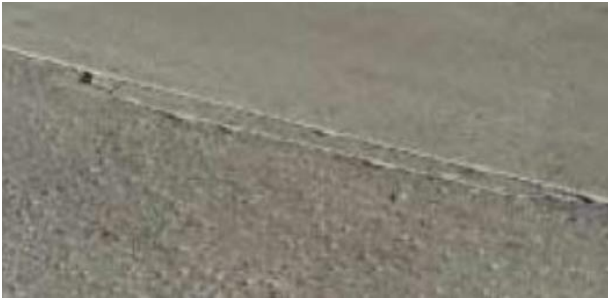
Imagen 31. Ejemplo de fisura por mal funcionamiento de juntas.
