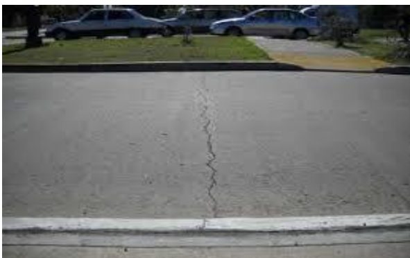
Imagen 20. Ejemplo de fisura transversal.
