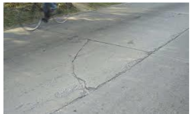
Imagen 22. Ejemplo de fisura de esquina.
