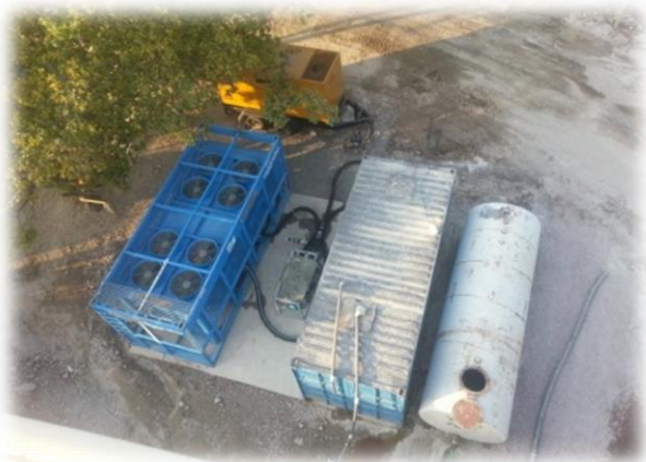
Imagen 1. Sistema de enfriamiento de agua, utilizado en el proyecto Cañas-Liberia (estructura azul a la izquierda: bomba y chiller, derecha: tanque de almacenamiento).
