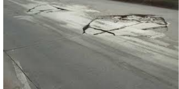
Imagen 25. Ejemplo de hundimiento de losa.
