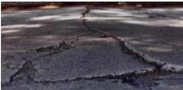
Imagen 24. Ejemplo de levantamiento de losa.
