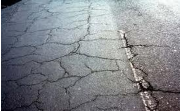
Imagen 23. Ejemplo de fisuras en bloque
