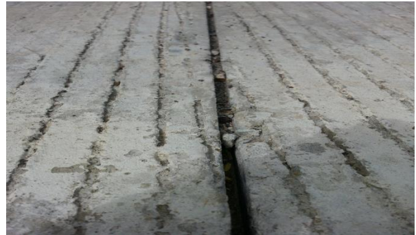
Imagen 29. Ejemplo de ausencia parcial de material de sello en una junta.
