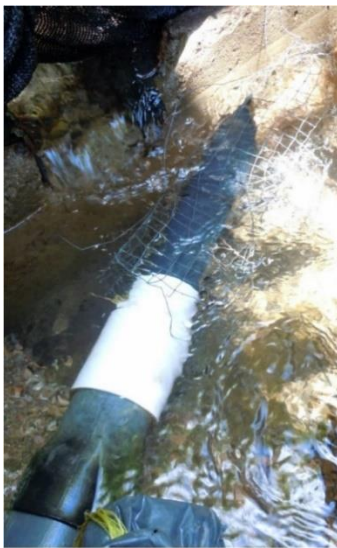
Figura 6. Tubo ubicado en la captación El Cubano, 2013.
