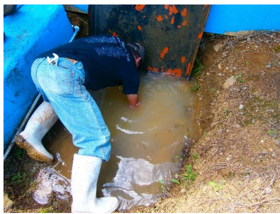
Figura A.4.10. Fuga en válvula bypass.
