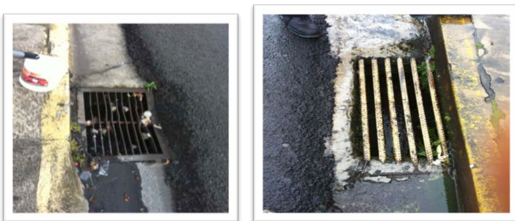
Figura 23. Alcantarillado pluvial subterráneo sin tapas de acceso en las cercanías de las propiedades
