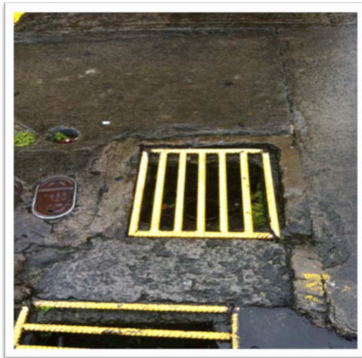
Figura 21. Salida de la caja de registro (arriba de la fotografía) con un nivel inferior a la salida del alcantarillado (parte baja de la fotografía)
