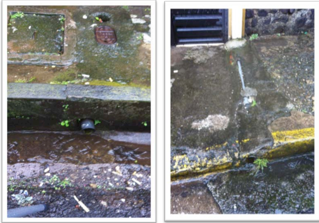
Figura 15. Comprobación de conexión ilícita por agua de lluvia
