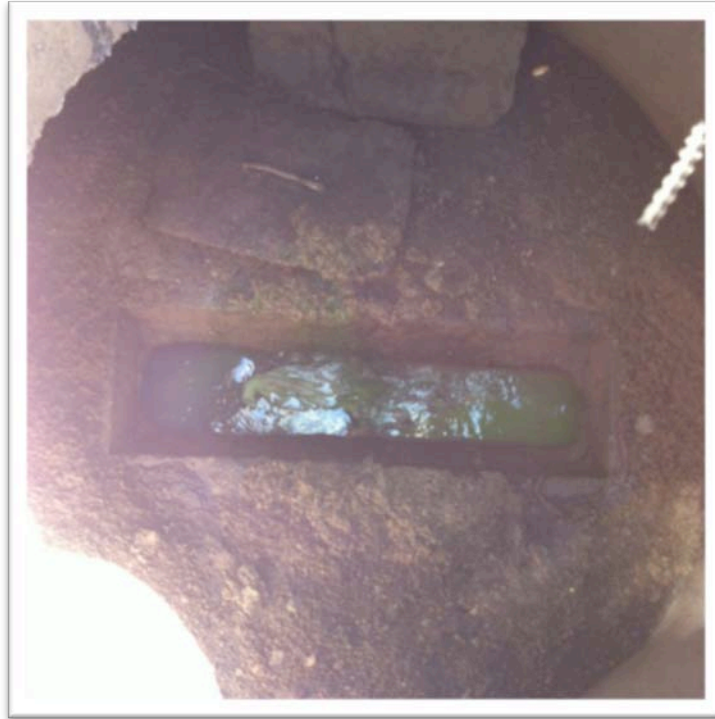
Figura 12. Prueba de tinte. Conexión pluvial ilícita conectada a la red sanitaria
