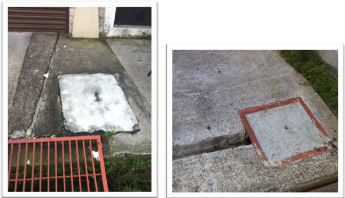
Figura 20. Caja de registro tapada
