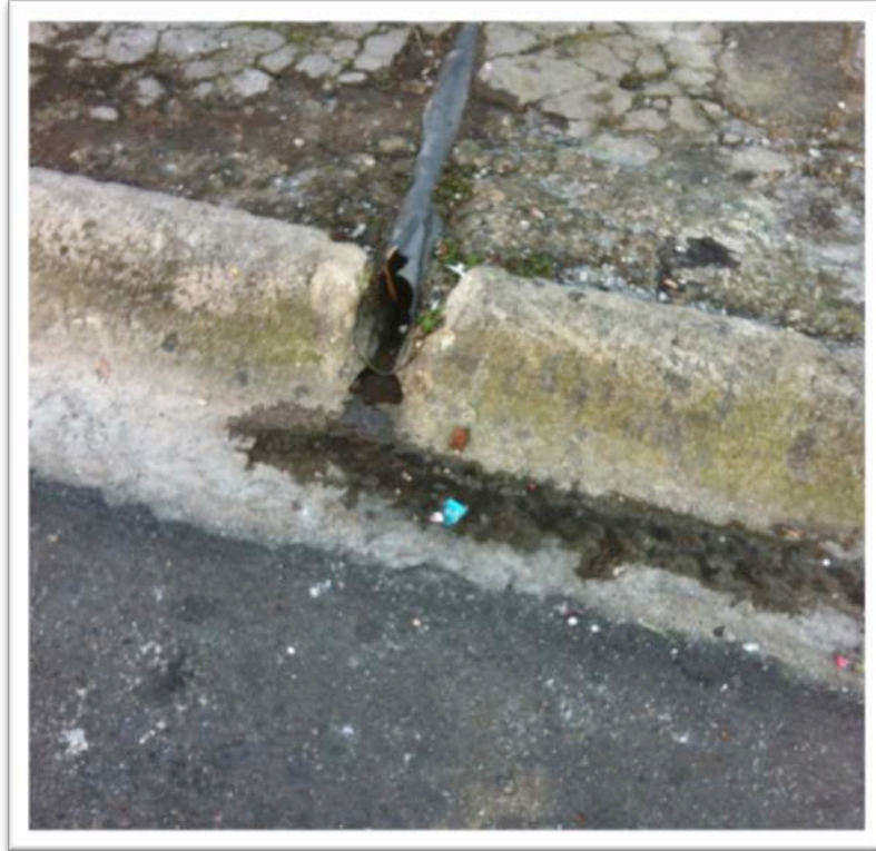
Fuente 14. Posible conexión sanitaria ilícita al alcantarillado pluvial
