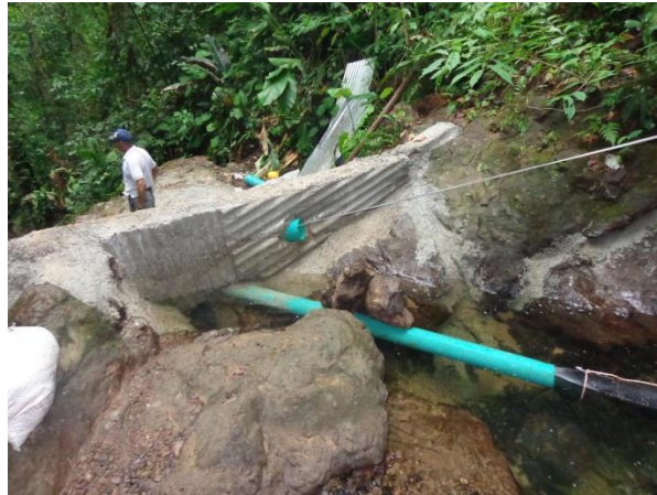
Figura 13. Captación La Gringa, se observa una represa de concreto colado en sitio; tubería sumergida cubierta con cedazo plástico. Fuente: Elaboración propia.
