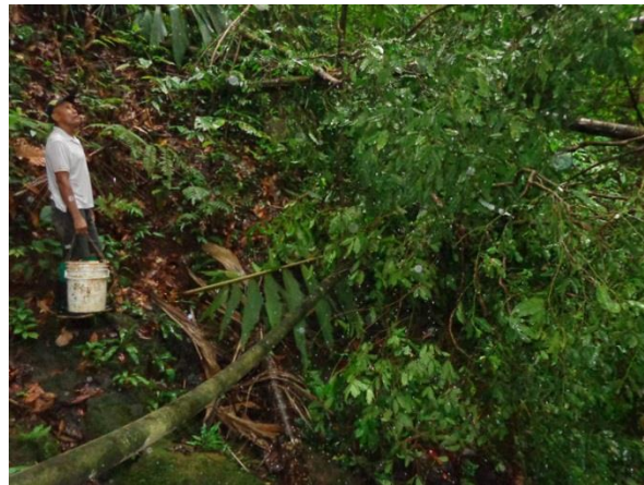
Figura 19. Ramas caídas sobre tramo de la conducción de la fuente Petrona. Fuente: Elaboración propia.
