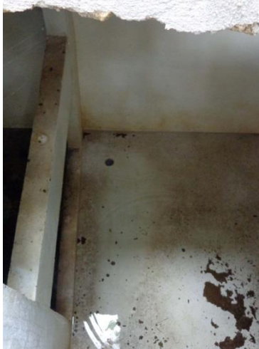
Figura 24. El tanque se encontraba vacío al momento de la visita. La superficie de su interior debe acondicionarse según criterios técnicos (por ejemplo superficie de concreto lujado).
