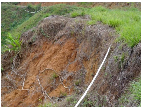
Figura 27. Tramos de tubería suspendidos en terrenos inestables, propensos a deslizamiento. Fuente: Elaboración propia
