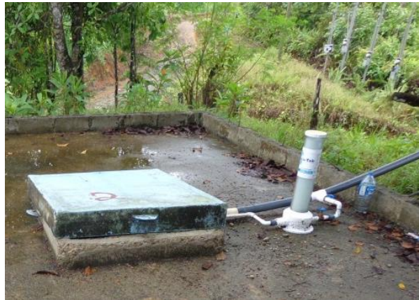
Figura 25. Clorador de hipoclorito de calcio instalado sobre la losa del tanque. Fuente: Elaboración propia.
