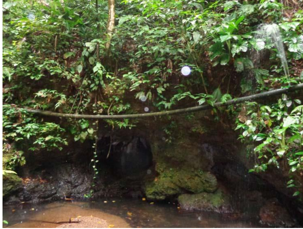
Figura 17. Conducción Petrona; tramo al margen de la quebrada justo después de la toma. Se observa una fuga a la derecha. Fuente: Elaboración propia.
