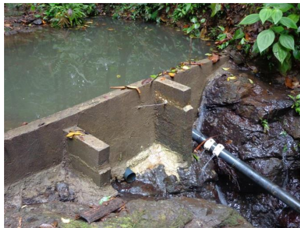
Figura 14. Captación Petrona, represa hecha con bloques de concreto, tubería sumergida. Fuente: Elaboración propia.
