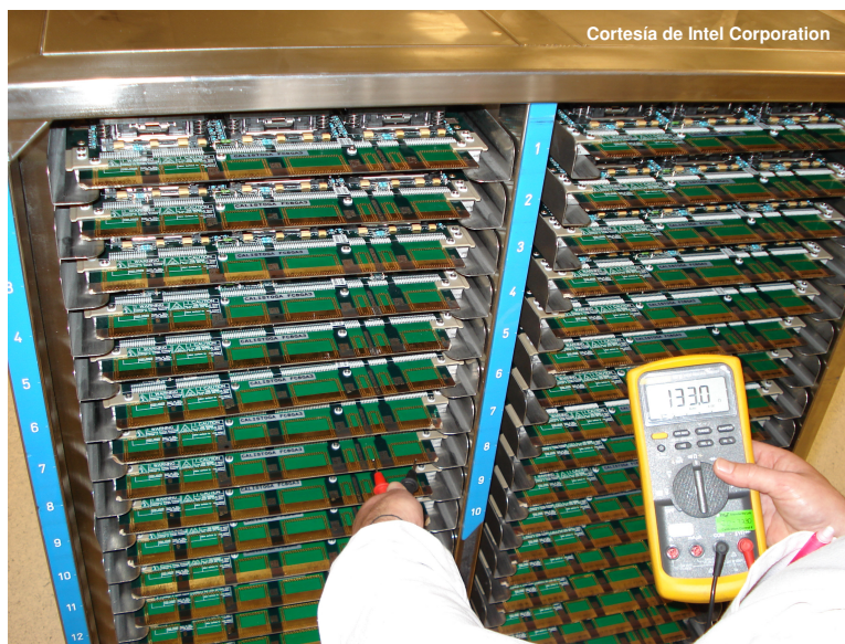
Figura 4.6. Medición de valores de resistencia en los terminales de alimentación de las tarjetas BIB.
