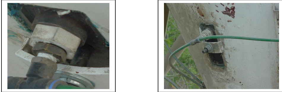
FIGURA 10.7 Aireadores instalados en silo y báscula
