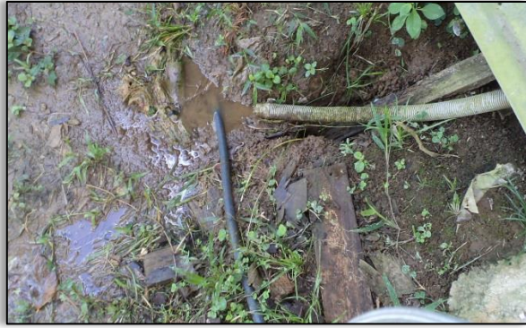
Descarga de aguas grises al suelo
