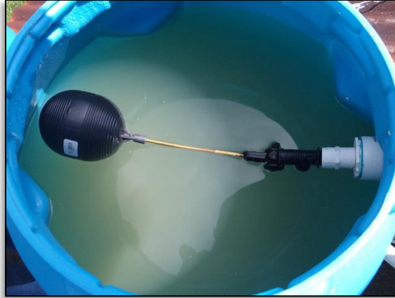
Figura 26.Boya corriente en el tanque #2.
