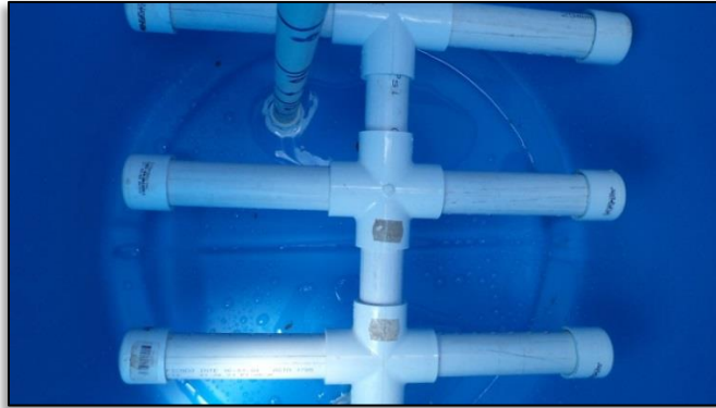
Figura 31. Drenaje de agua filtrada en el tanque #4.
