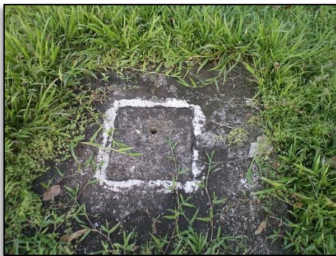
Tanque séptico sin ventilación
