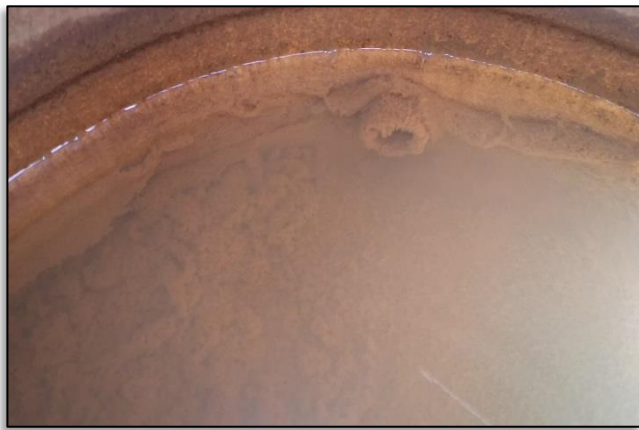
Figura 41. Sedimento formado en tanque #1
