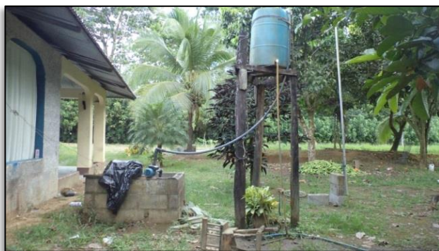
Captación de agua de pozo perforado
