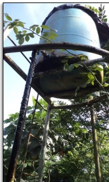
Tanque de almacenamiento
