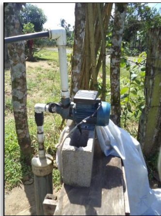
Bomba de 0.5 HP de un pozo perforado
