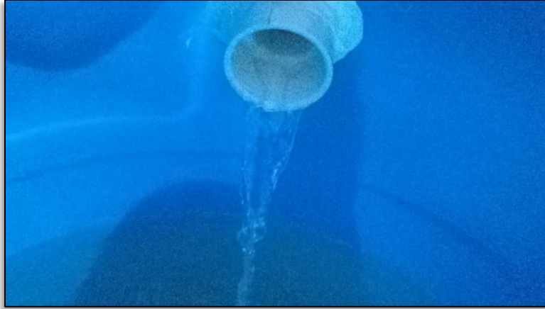
Figura 33. Entrada de agua filtrada en tanque #5
