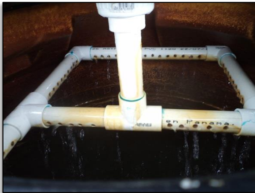
Figura 38. Dispositivo de aireación corroído
