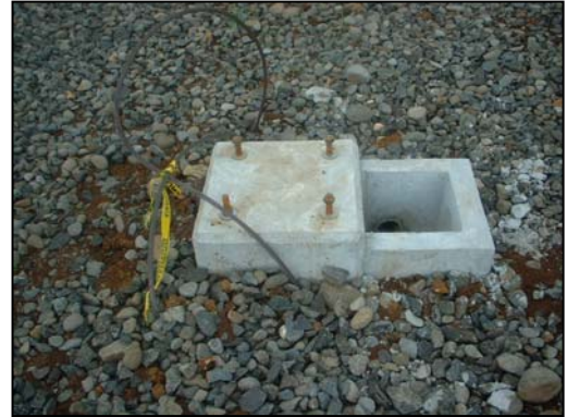
Cimiento y Caja de registro en la subestación de Arenal. Tierra y pernos listos para montaje.
