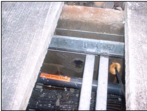
Tubo PVC de 2 pulg. que llega al ducto principal que va hasta la sala de control.
