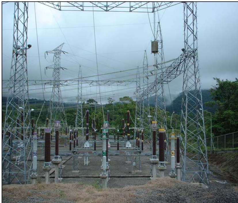
Sistema OPLAT en funcionamiento en la subestación de Arenal. Al fondo trampa de bloqueo que cuelga de la estructura de las líneas de alta tensión.
