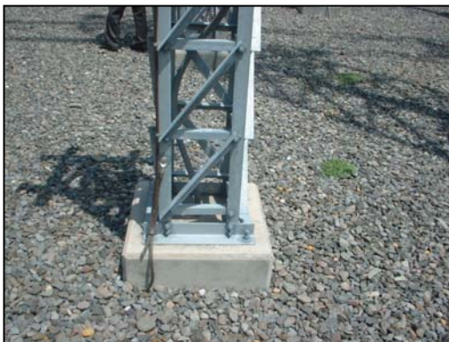
Conexión de la malla de tierra a la torre monopolar y extensión para el AKE.
