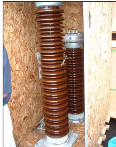
Revisión del estado y puntos de conexión de los condensadores de acoplamiento.
