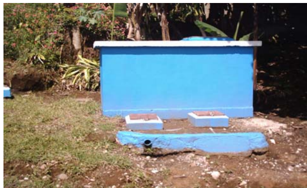
Tanque Quebragradiente 2m 3
