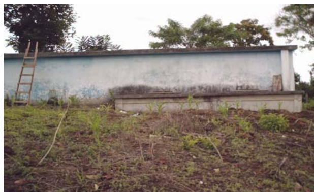
Tanque de almacenamiento 300m 3
