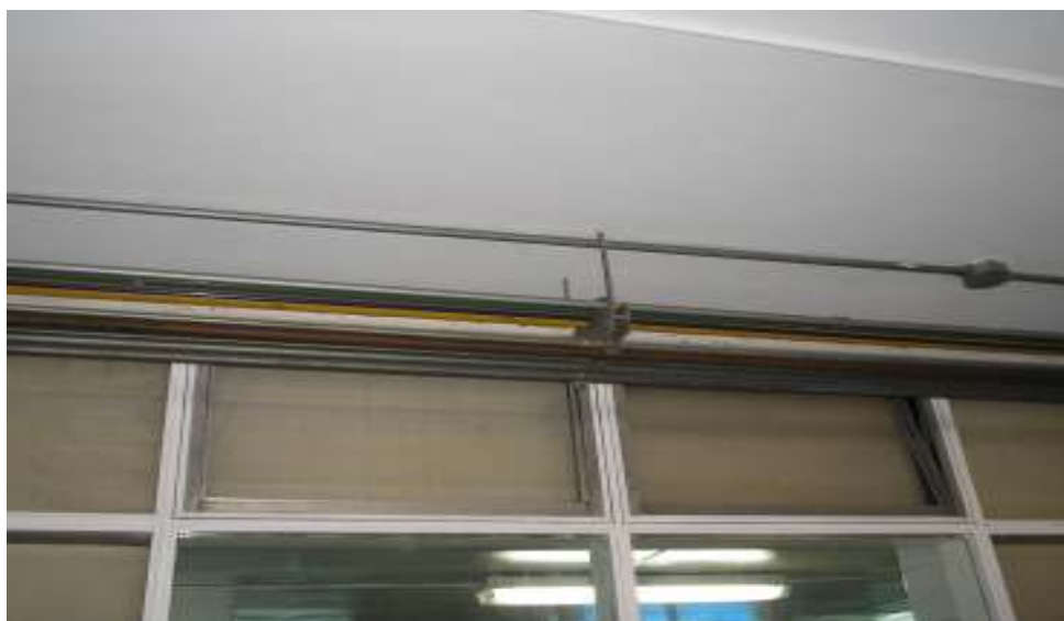
Figura 4.3.4.1. Soportes metálicos de las tuberías de gases médicos
