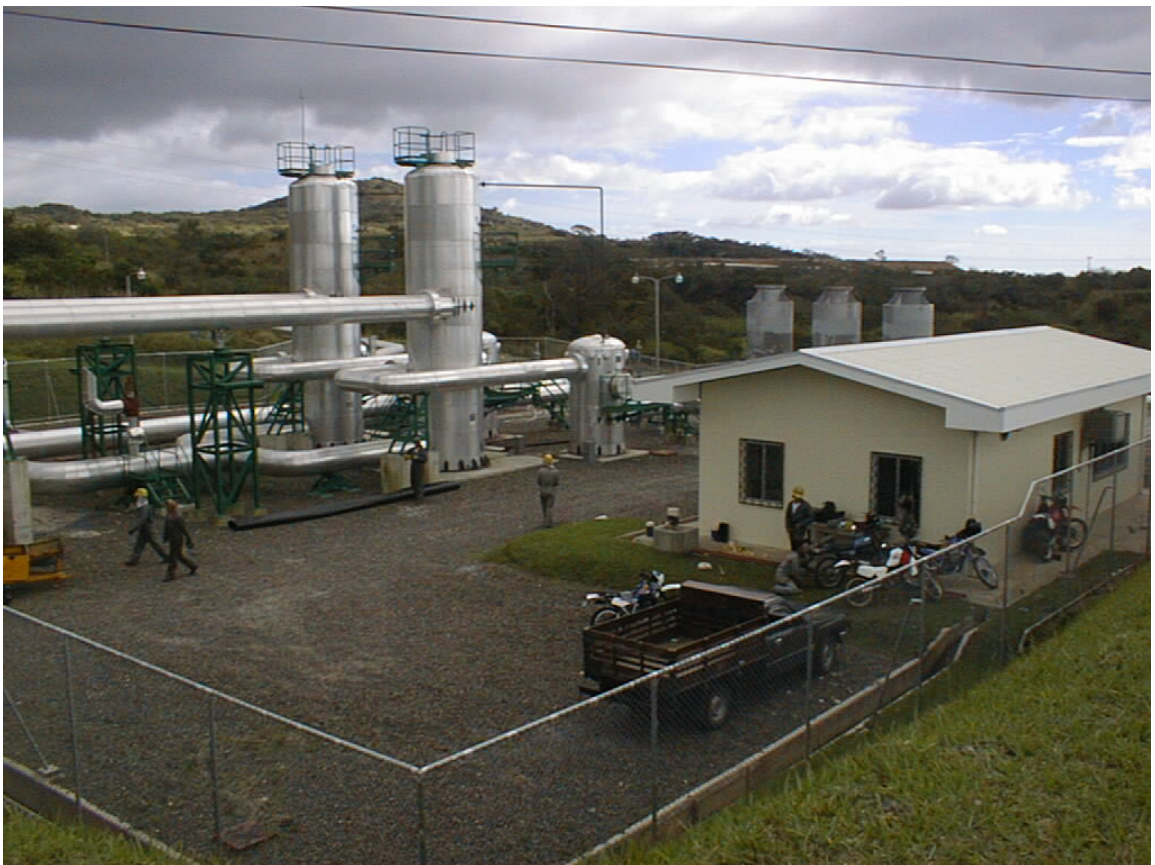
Figura 1.3 Estación separadora (satélite 7)
