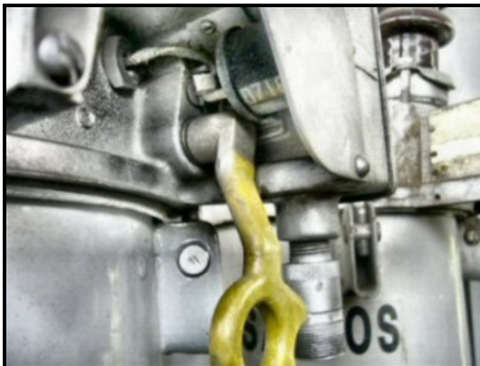
Manija y contador de operaciones del recloser
