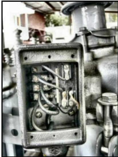
Caja de cableado del recloser
