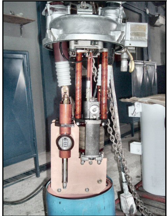
Vista general del recloser fuera del tanque
