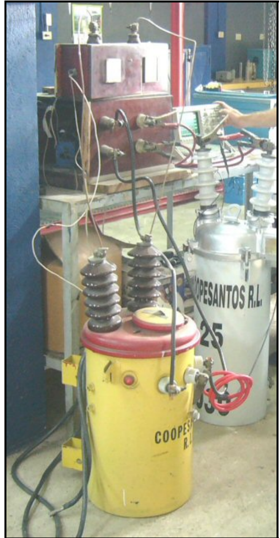
Fuente de corriente utilizada en la medición de parámetros
