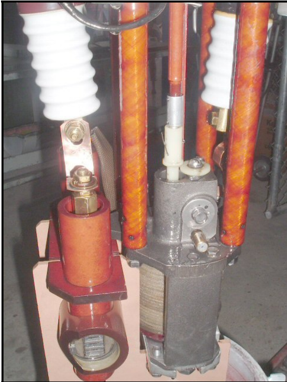
Cámaras de aceite encargadas de la operación del recloser
