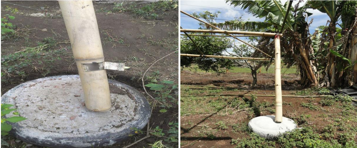
Figura 12. Bases para la estructura primaria. Llantas con mezcla de concreto que le dan soporte a las bases de bambú Foto propia.
