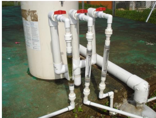
Figura 2. Sistema de desinfección en tabletas de hipoclorito de calcio
