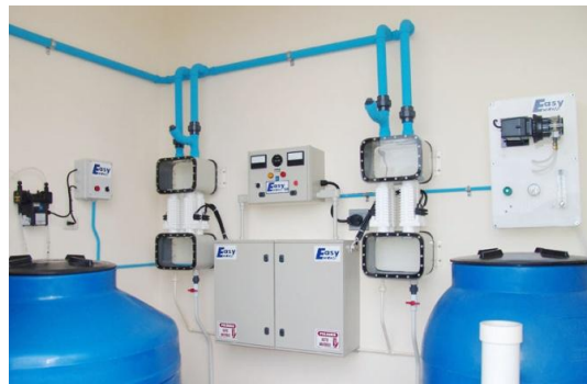
Figura 1. Equipo de desinfección con hipoclorito de sodio
