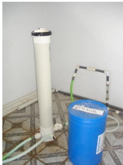
Figura 5. Sistema de cloración de cámara húmeda (ACI), instalado en Horquetas de Sarapiquí
