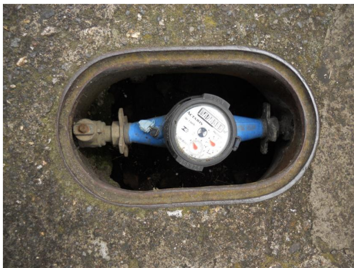
Figura 17. Medidor de agua potable sin tapa.
