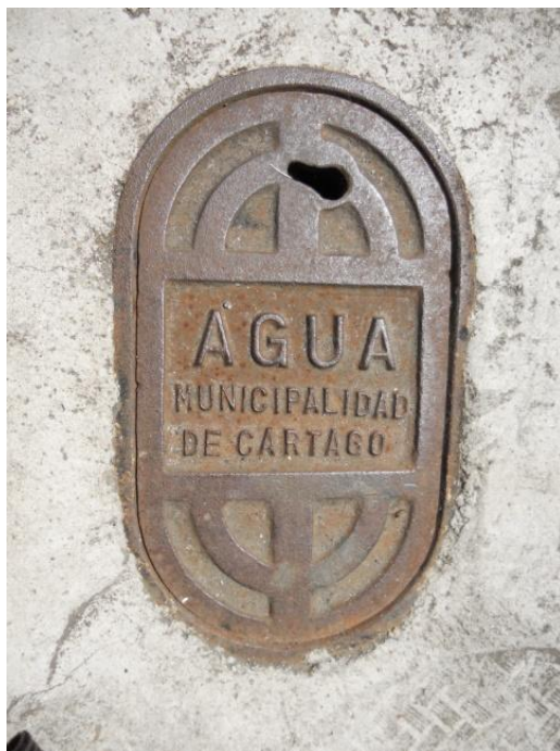
Figura 16. Medidor de agua potable con tapa.
