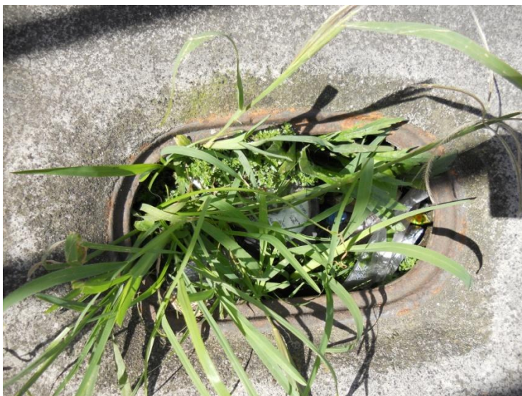
Figura 19. Medidor de agua potable sin tapa y con maleza.
