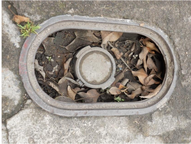
Figura 21. Medidor de agua potable sin tapa y con pantalla no visible.
