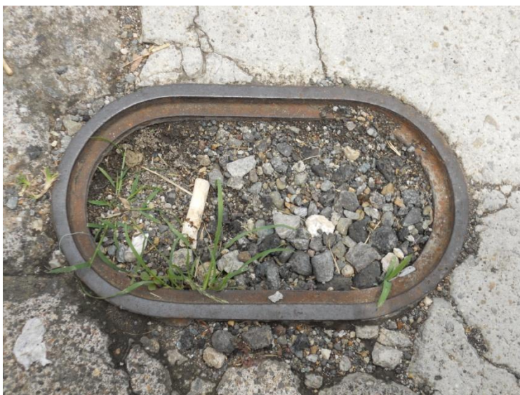
Figura 20. Medidor de agua potable sin tapa y enterrado.
