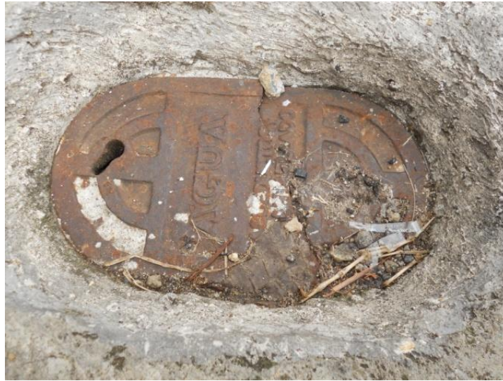
Figura 18. Medidor de agua potable con tapa quebrada.
