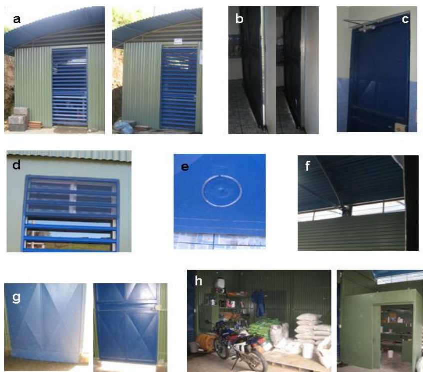
Figura 9. Mejoras realizadas por el socio número cinco; a) cuarto de máquinas; b) puerta principal cuarto de almacenamiento y enfriamiento de la leche; c) puerta pequeña cuarto de almacenamiento y enfriamiento de la leche; d) ventana cuarto almacenamiento y enfriamiento de la leche; e) escotilla para la manguera de recolección de la leche; f) tapichel; g) puertas área de ordeño; h) bodega de agroquímicos y productos veterinarios.
