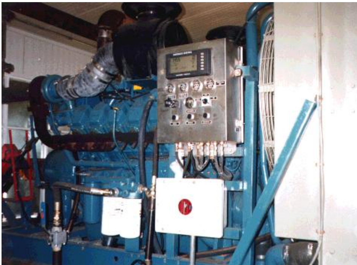
Figura A1.3 Fotografía del motor de bombeo de frecuencia variable utilizado en el plantel de Moín para el bombeo de producto
