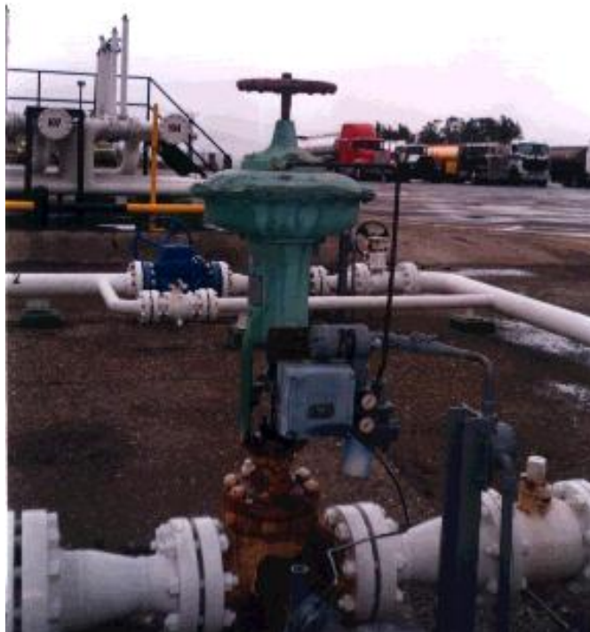
Figura A1.2 Fotografía de la válvula Fisher de control utilizada en el plantel del Alto de Ochomogo.
