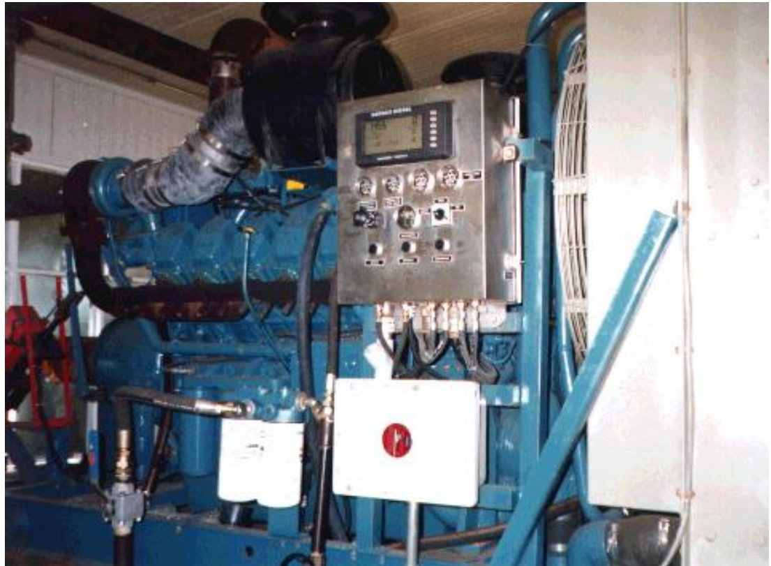
Figura 2.2 Fotografía del motor de bombeo de frecuencia variable utilizado en el plantel de Moín para el bombeo de producto.
