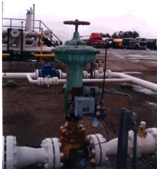
Figura 2.3 Fotografía de la válvula Fisher de control utilizada en el plantel del Alto de Ochoмого.
