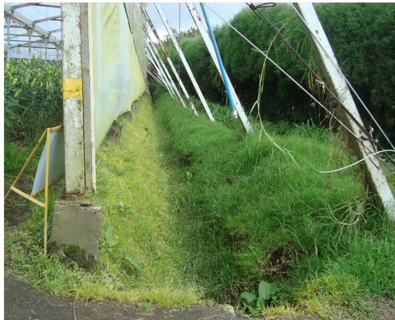
Anexo 12. Bases de invernaderos afectadas ante trabajos de maquinaria pesada.
