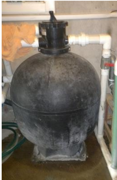
Fotografía 7.6 Filtro de arena.
