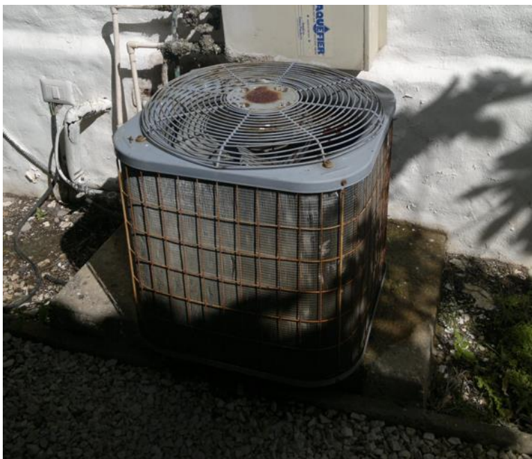
Fotografía 7.5 Unidad condensadora 12000 Btu Carrier Mod. 24ABB3.
