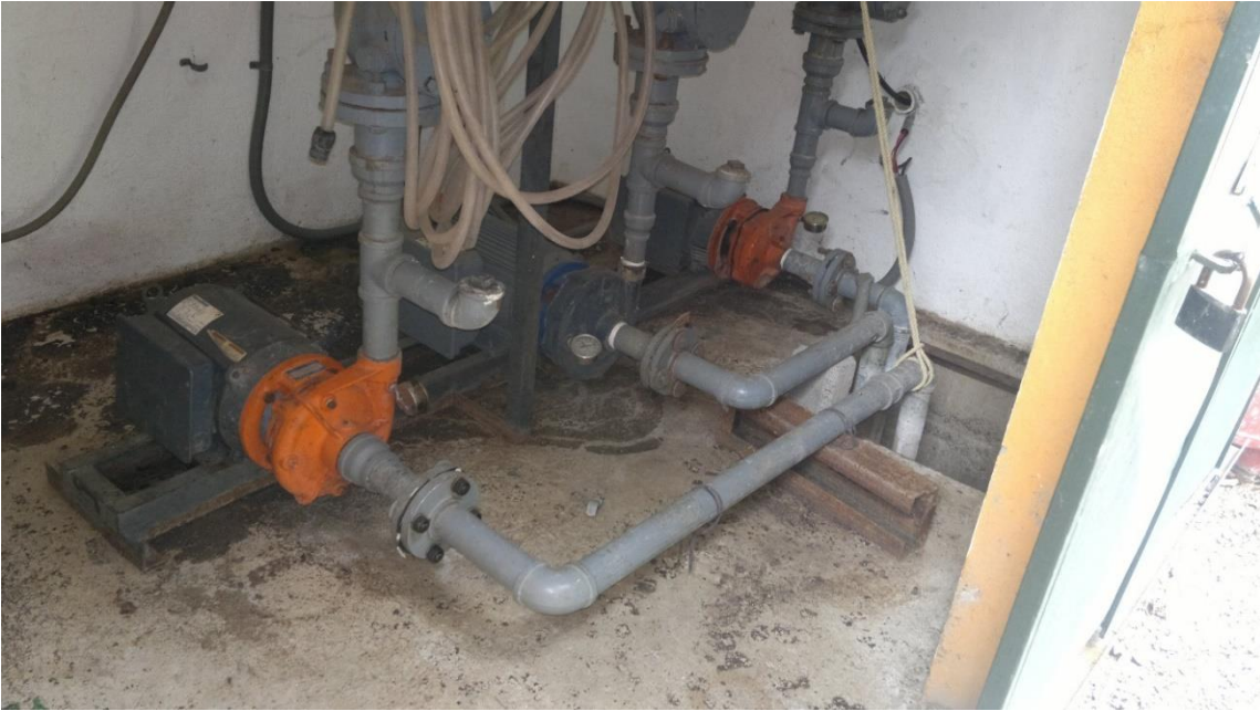
Fotografía 7.3 Motor-Bombas centrifugas (BALDOR 213T TEFC Mod. EM3770T) de agua tratada a tanques de Sistema de Riego.
