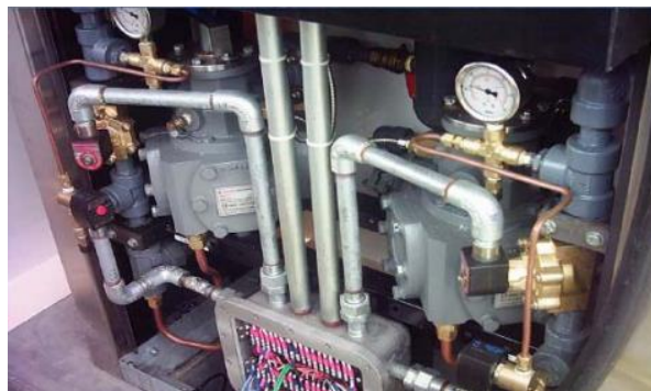
Ilustración 32. Ejemplo de tuberías eléctricas herméticas.
