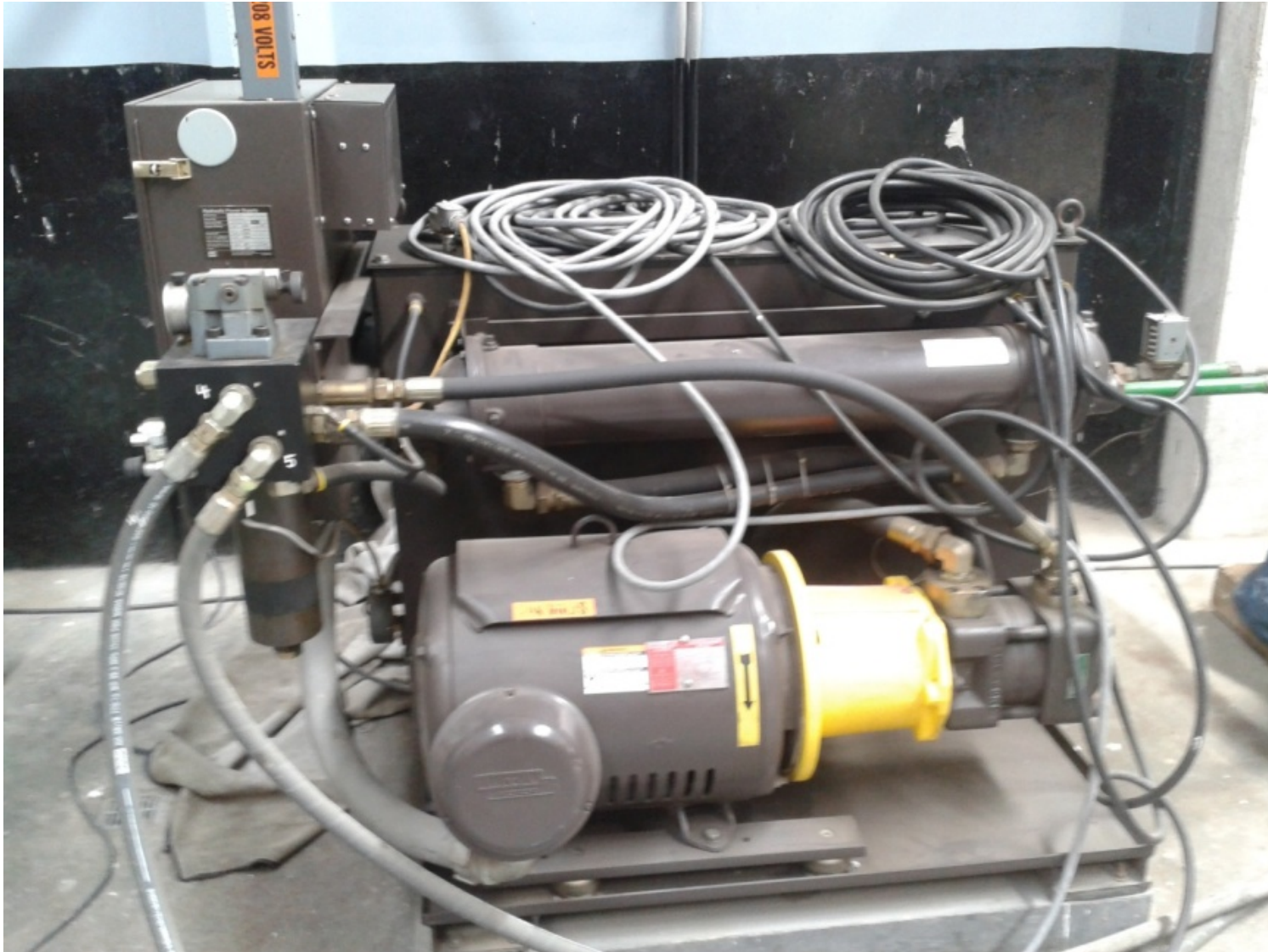
Imagen 24. HPU marca MTS® modelo 510.21C instalada en el laboratorio de estructura civil del LanammeUCR.
