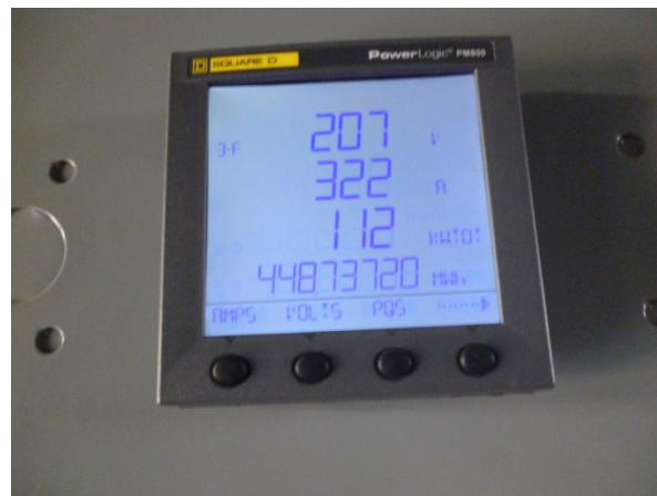
Figura 9. Equipo de medición Power Logic PM800
