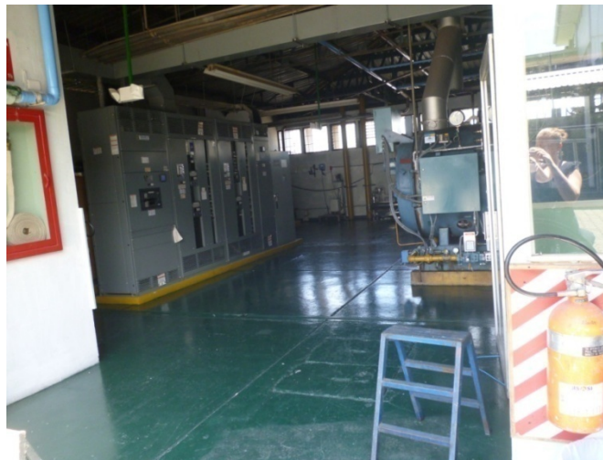
Figura 8. Casa de máquinas del HCLVV
