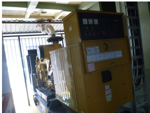
Figura 11. Planta de emergencia marca CATERPILLAR
