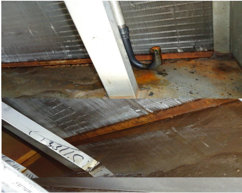
Figura 4-5 Fotografías del evaporador
