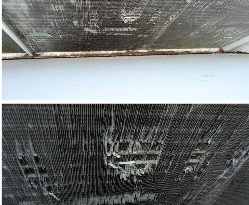
Figura 4-4 Fotografías del condensador lado izquierdo
