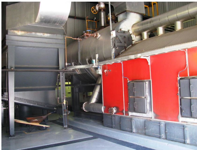
Figura 3.6. Caldera biomásica VYNCKE. 13
