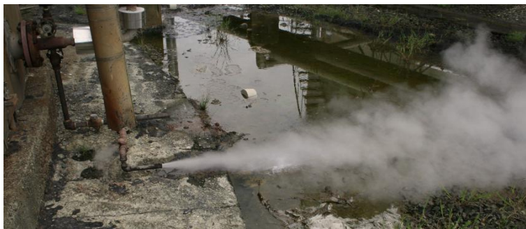
Figura 1.1 Descarga de trampa de vapor termodinámica, área de asfaltos, Plantel Refinería RECOPE.
