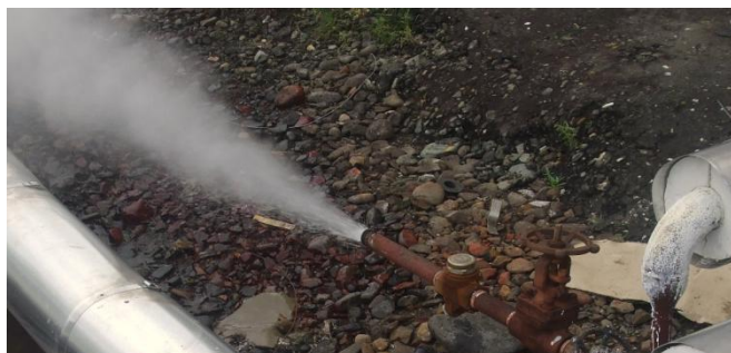
Figura 5.8 Trampa para vapor tipo termodinámica instalada en calentador de asfalto, Plantel de Refinería RECOPE S.A.
