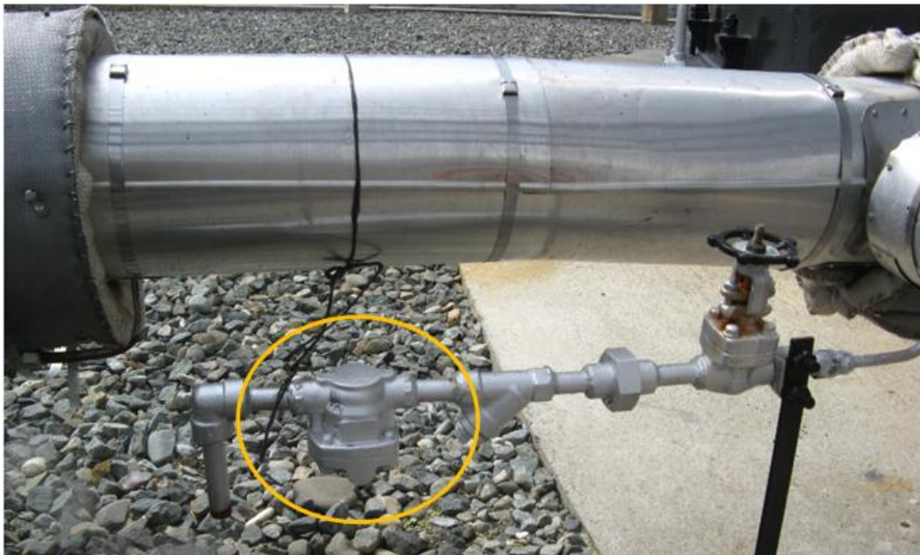
Figura 5.4 Trampa para vapor tipo flotador en traza de tubería de crudo pesado, Plantel de Refinería RECOPE S.A.
