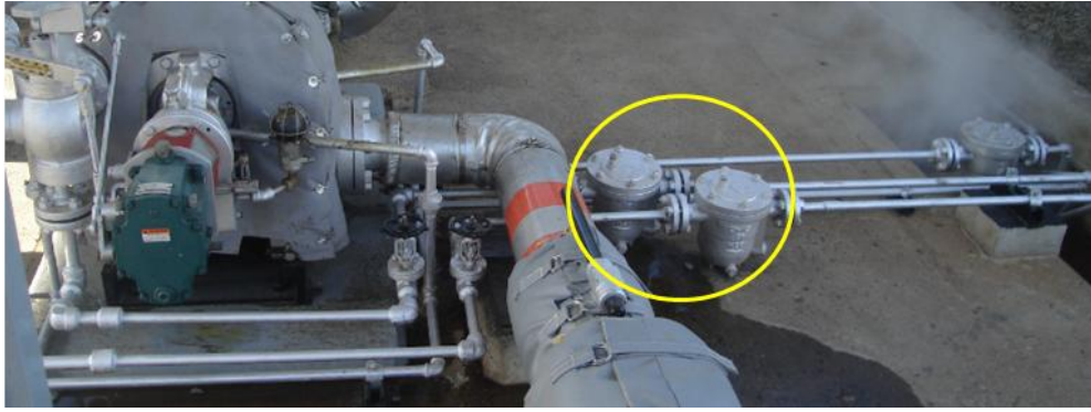
Figura 5.5 Trampas para vapor tipo flotador en bombas de trasiego de IFO, Plantel de Refinería RECOPE S.A.
