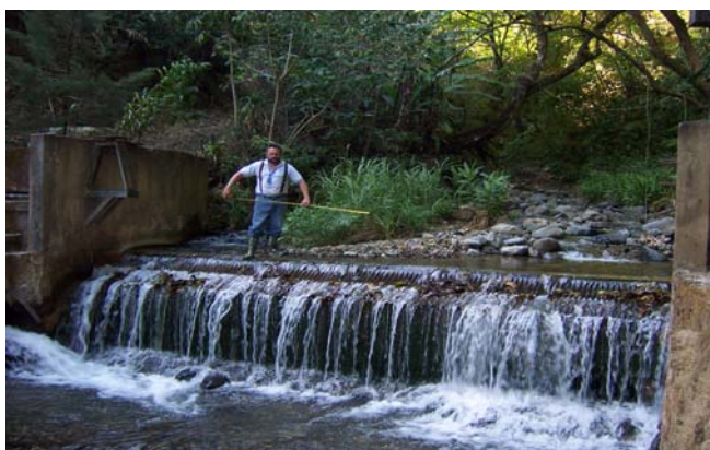
Fig. 1-A. Presa de derivación a filo de agua en la subcuenca del río Jorco.
