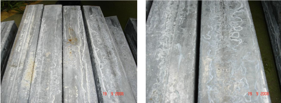
Figura 3.3 y 3.4: Formación de corrosión en las caras de los tubos en sectores Internos del paquete.
