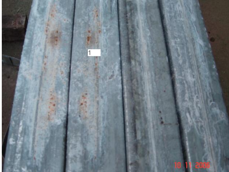
Figura 3.12: formaciones de óxidos de hierro en las caras de los tubos.
