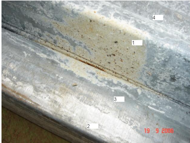
Figura 3.8: formación de corrosión en las caras de los tubos en sectores Internos del rollo
