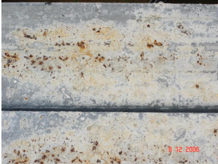
Figura 3.16: Formaciones de óxidos de hierro por fallo del recubrimiento de zinc.
