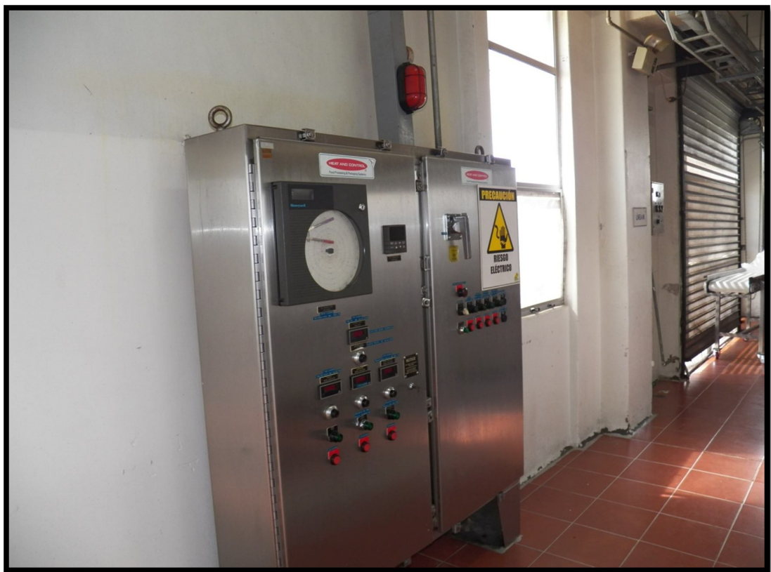
Figura 5.2 Armario de control y armario de potencia.
