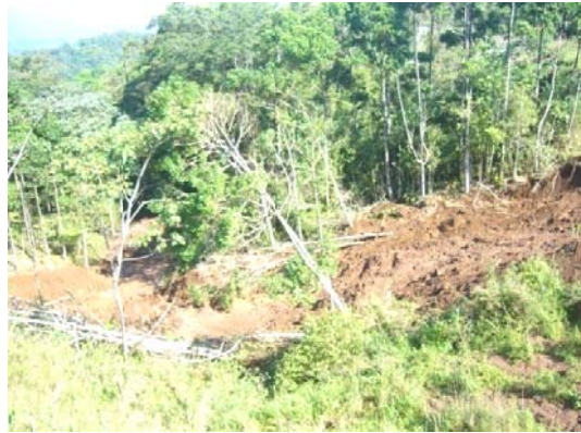
Figura 6. Botadero de las obras carretera San Carlos-San Ramón
