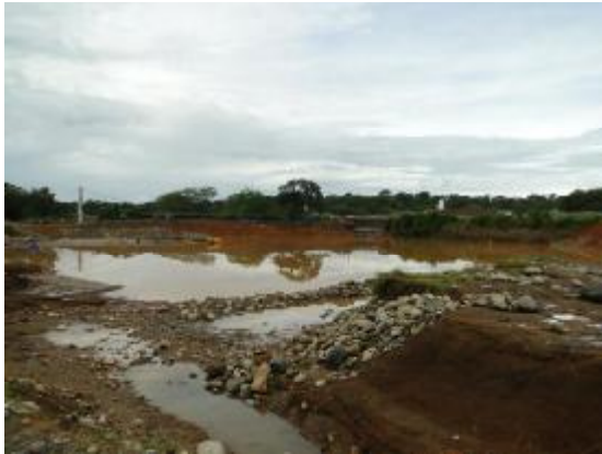
Figura 15. Sitio de presa inundado por crecida de río Fonseca, PHSL
