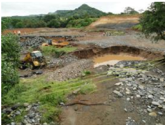
Figura 17. Equipo arrastrado por crecida del río, PHSL
