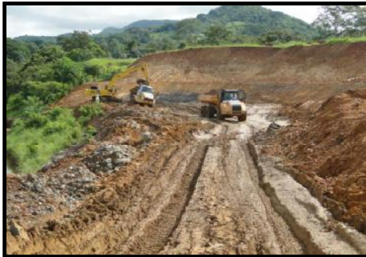
Imagen 14. Camino en mal estado debido a lluvias, PHSL
