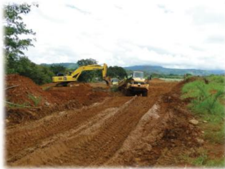
Imagen 2. Malas condiciones del acceso a zona de excavación.
