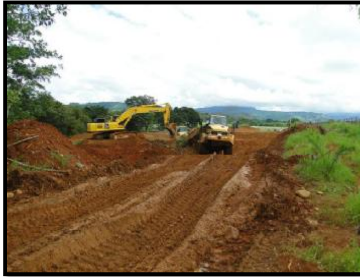
Imagen 13. Accesos en mal estado PHSL
