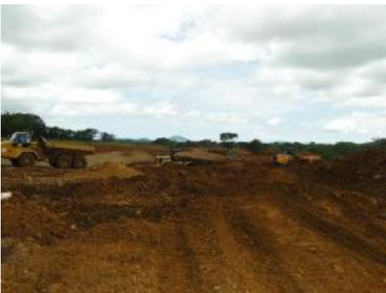
Figura 10. Caminos en mal estado, PHSL
