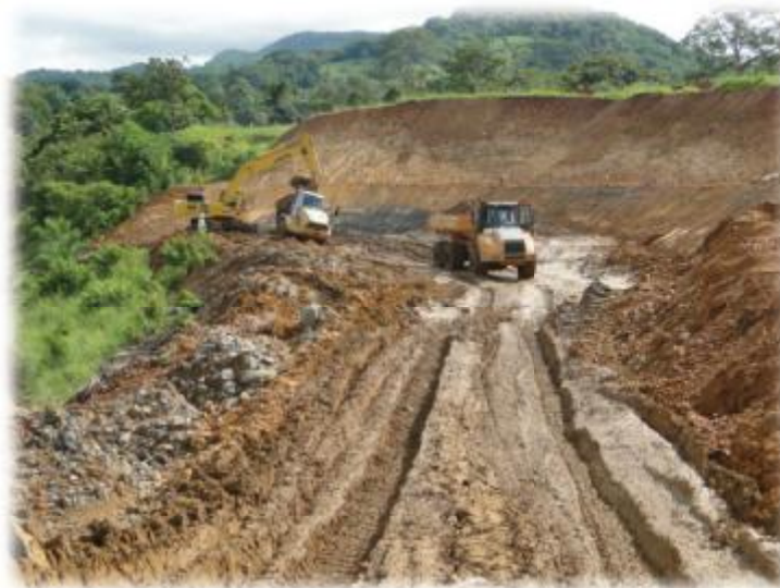
Imagen 1. Condiciones adversas del camino en el sitio de excavación.
