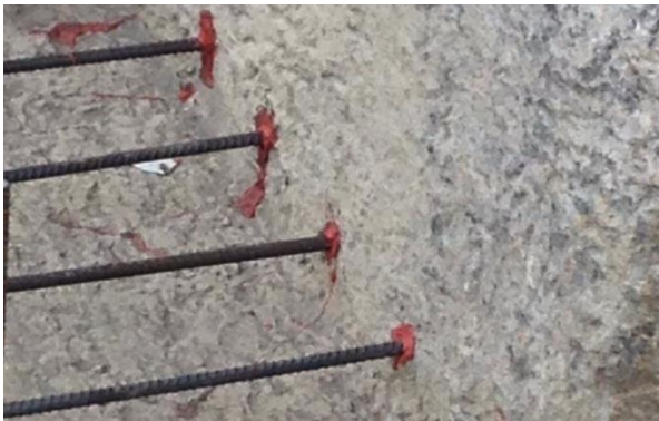
Figura 10. Colocación de acero con epóxico en la placa de fundación de pila 3.
