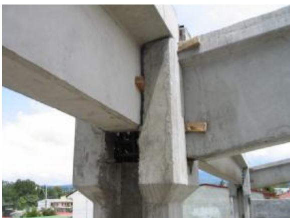
Imagen #13: Unión de columna (en capitel) con viga cercha y viga canoa.
