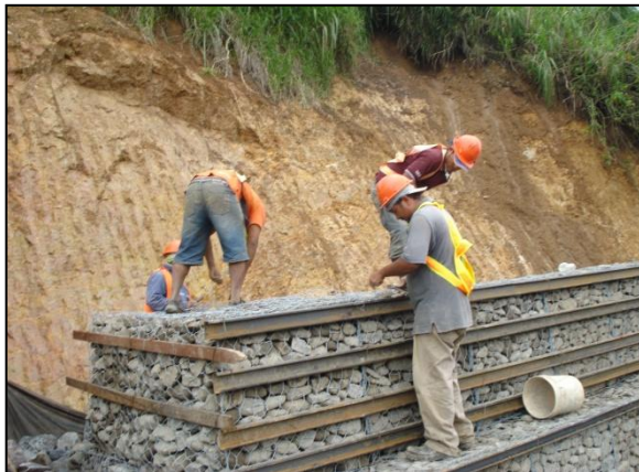
Figura 5. Cierre de la celda de gaviones de 9 m3 Fuente: tomada por el autor
