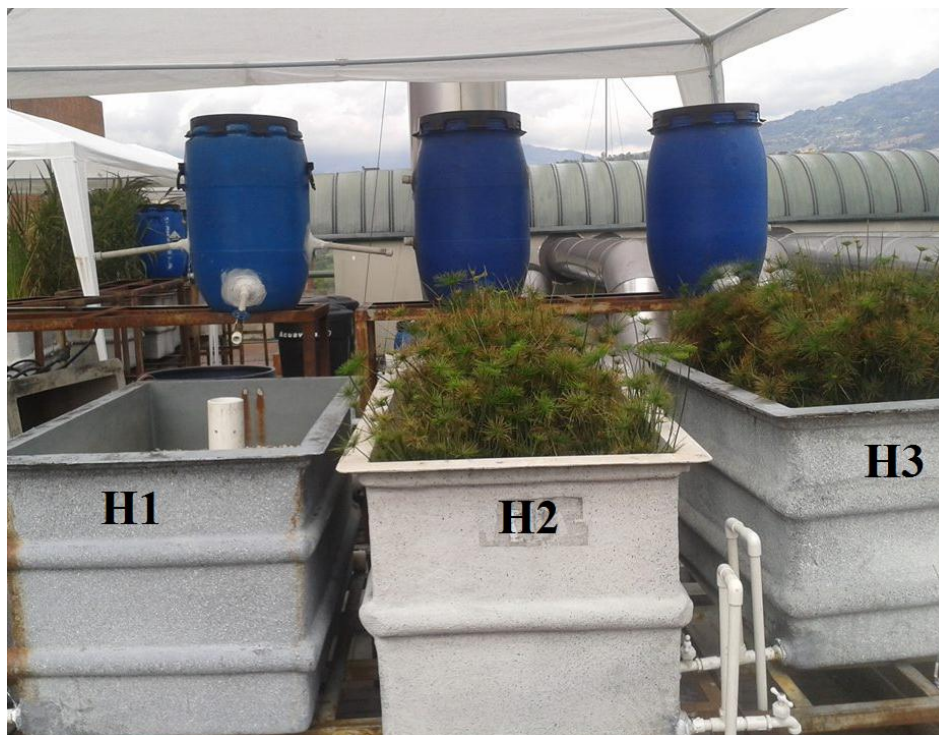
Figura 3.2 Instalación de los tres humedales. Humedal 1 sin plantar y humedal (2 -3) con macrófitas.
