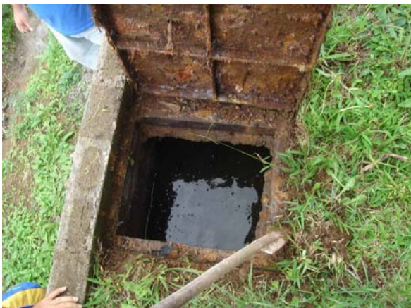
Fotografía 5. Tanque séptico en lindero de la propiedad, irrespetando separaciones mínimas requeridas.
