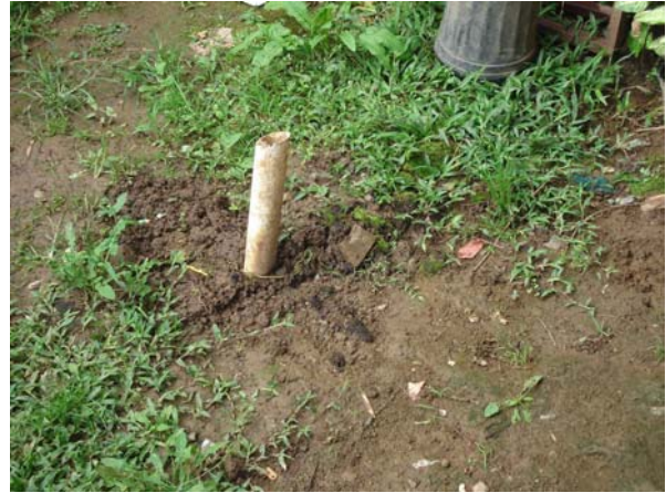
Fotografía 6. Ventilación de un sistema de tanque séptico.
