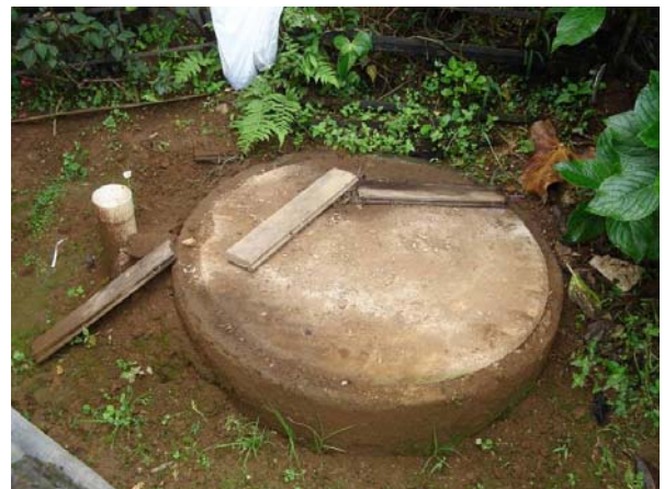
Fotografía 3. Tanque séptico hecho con alcantarillas e irrespetando relaciones de tamaño.
