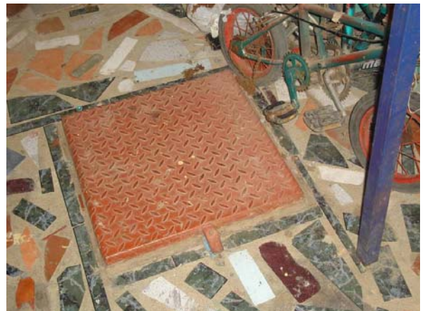
Fotografía 7. Tanque séptico dentro de la vivienda sin sellos adecuados para evitar el escape de gases hacia el interior de la vivienda.
