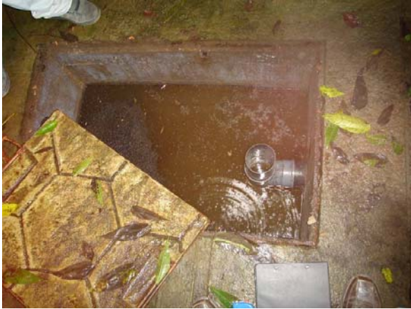
Fotografía 4. Tanque séptico de dimensiones inadecuadas. Se toma la referencia la figura de salida que es en 0.10m, para establecer la irregularidad de las dimensiones.
