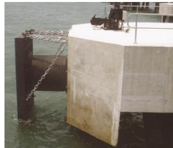
Figura 90. Duques de alba en megapuerto (Shibata, 2002)
