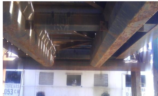
Figura 30. Corrosión de miembros estructurales de la rampa. (Fuente: del Autor)
