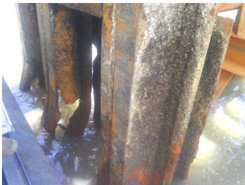
Figura 2. Deterioro de duques de alba actuales (Fuente: del Autor)
