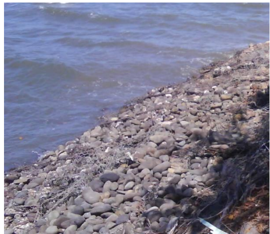
Figura 40. Colchonetas de protección rotas. (Fuente: del Autor)
