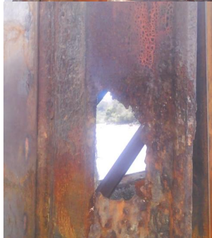
Figura 34. Elementos parcialmente desintegrados. (Fuente: del Autor)
