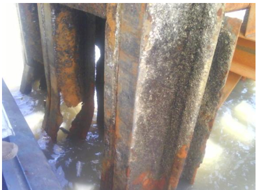
Figura 35. Deflexión de los pilotes de tablaestaca debido al impacto del ferry. (Fuente: del Autor)
