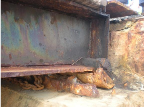
Figura 32. Detalle del deterioro del apoyo izquierdo de la rampa. (Fotografía cortesía del Ing. Gilberto Rodríguez)
