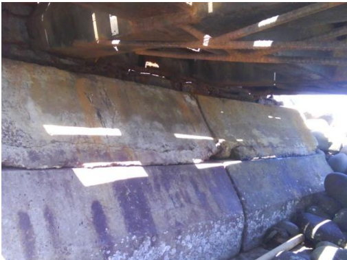
Figura 33. Detalle del agrietamiento de la base de la rampa de acceso. (Fuente: del Autor)
