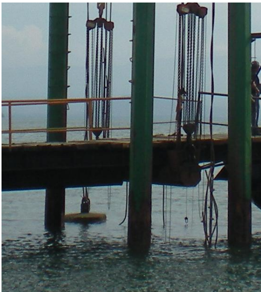
Figura 39. Detalle de corrosión del marco de izaje y contrapesos sumergidos. (Fotografía cortesía del Ing. Gilberto Rodríguez)
