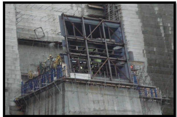
Figura 37. Embocadura de toma de agua con formaleta alrededor para realizar colada y dejar la base de la estructura embebida.
