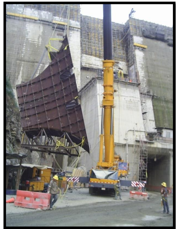
Figura 10. Grúa móvil de capacidad 50Ton en montaje de embocadura de toma de agua, la embocadura pesa 17Ton.
