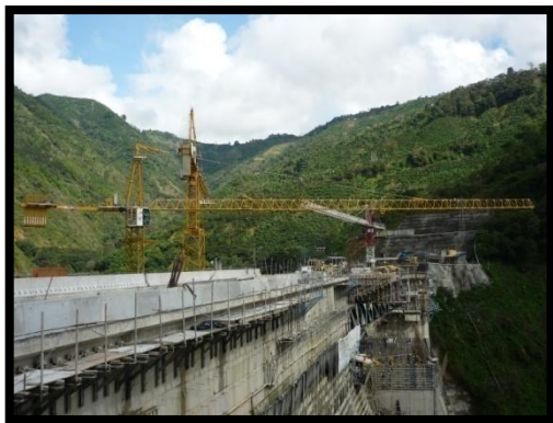
Figura 11. Grúas torre instaladas sobre la cresta de la presa, esta ubicación permite tener alcance al área de construcción de la torre de compuertas.
