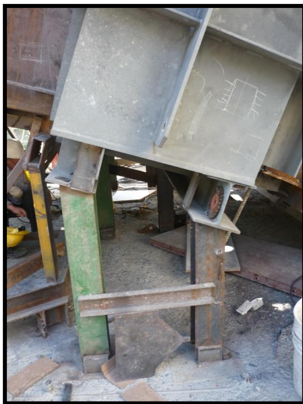
Figura 36. Columnas de apoyo para posicionar el nicho de la compuerta de la toma de agua.
