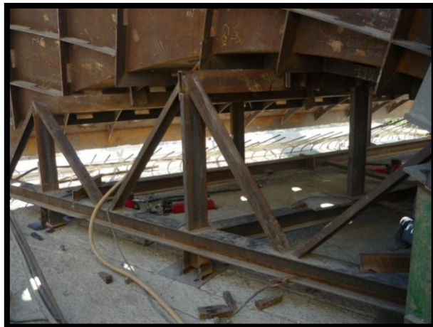
Figura 35. Estructura de apoyo en forma de cercha sobre la cual se apoya la embocadura de la toma de agua.
