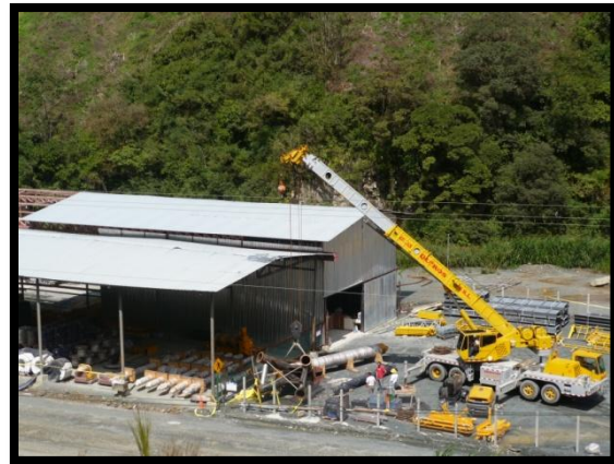
Figura 12. Patio de almacenamiento de elementos metalmecánicos cerca del sitio de construcción de la torre de compuertas.
