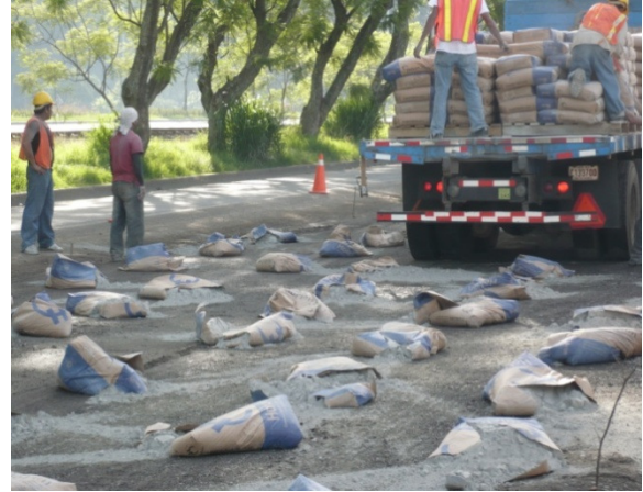
Figura 18. Colocación del cemento sobre la base para luego ser recuperada y estabilizada. (Fuente: El autor)
