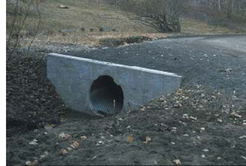
Figura 18. Una alcantarilla bien diseñada e instalada con muros de cabecera, para mejorar la eficiencia y para la protección o retención del material de relleno. (Fuente: Guía de Campo para las Mejores Prácticas de Administración de Caminos Rurales)
