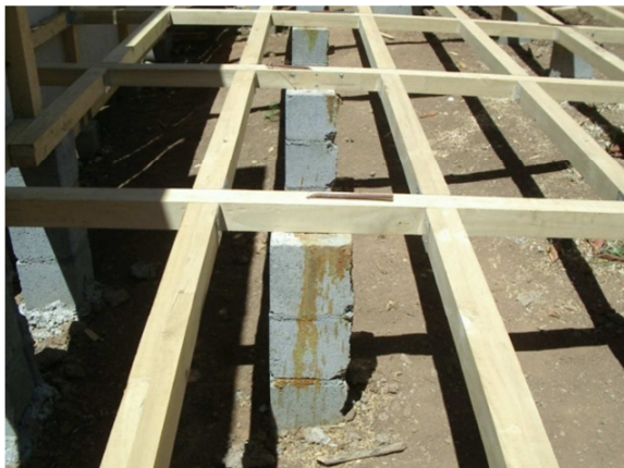
Figura 1. Sistema de viguetas de Entrepiso o piso de la solución con estructura de madera.
