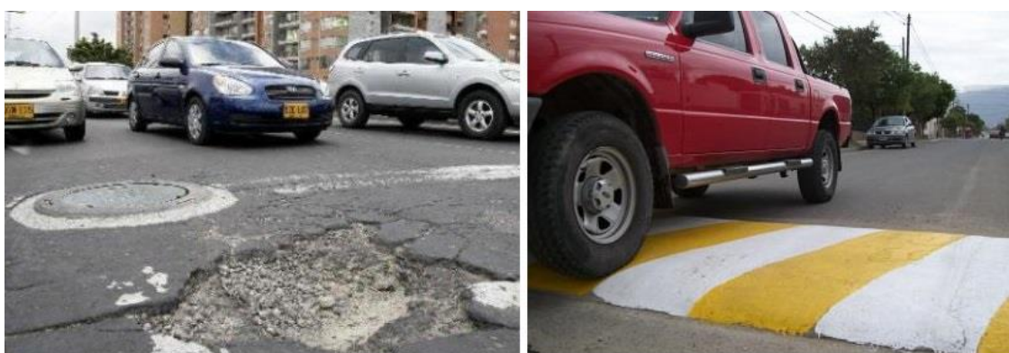
Figura 21: Muestra del estado de carreteras
