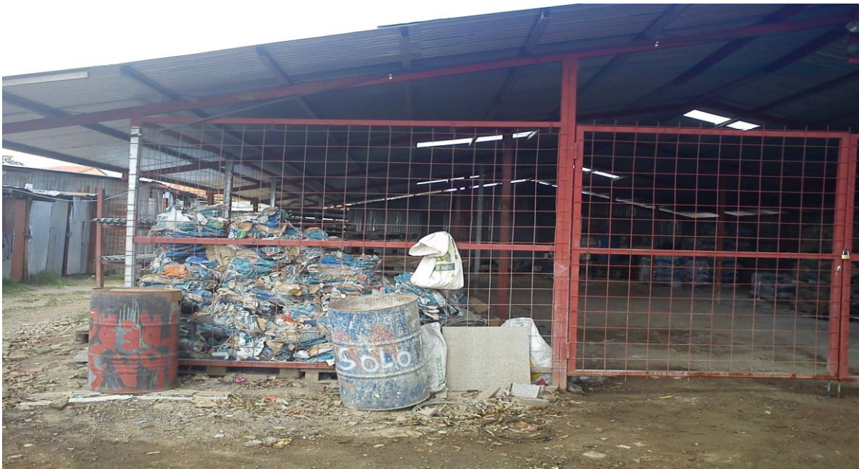
Figura N°5. Bodega de materiales – Área de almacenamiento de sacos de cemento, bondex y impermeix. Marzo, 2014
