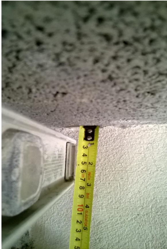
Figura N°38. Medida de la deformación del cielo en la casa 8-H.
