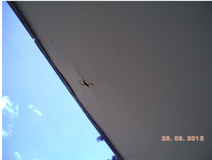
Figura 8. Huecos en láminas de Gypsum Fachada frontal.
