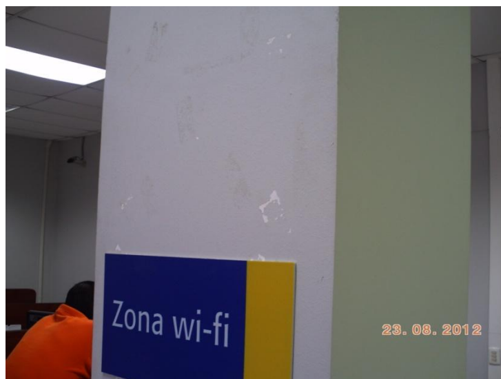
Figura 4. Deterioro por rótulos que se eliminan.
