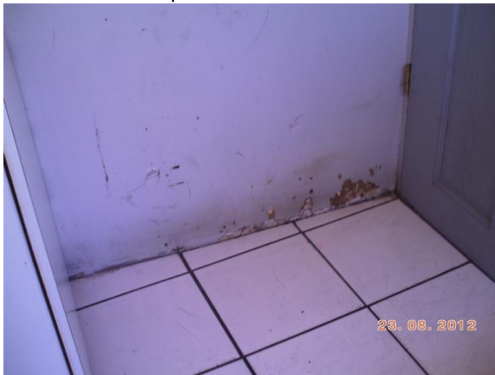
Figura 3. Deterioro por descuidos y falta de mantenimiento.
