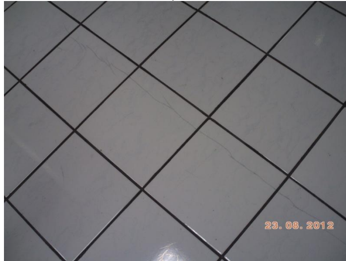
Figura 14. Deterioro de la cerámica (Oficina jefatura).
