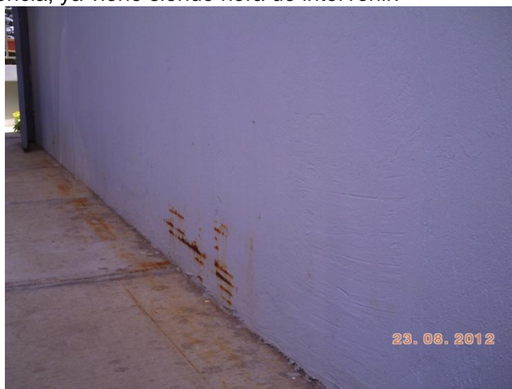
Figura 1. Deterioro por arreglos en la Agencia.
