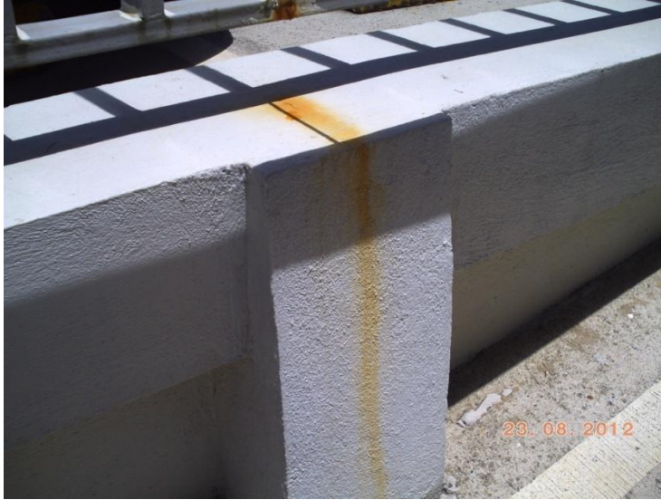
Figura 2. Deterioro por elementos ajenos.
