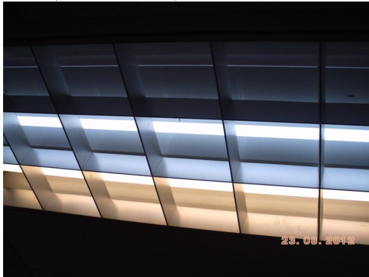
Figura 10. Tubos fluorescentes en mal estado.
