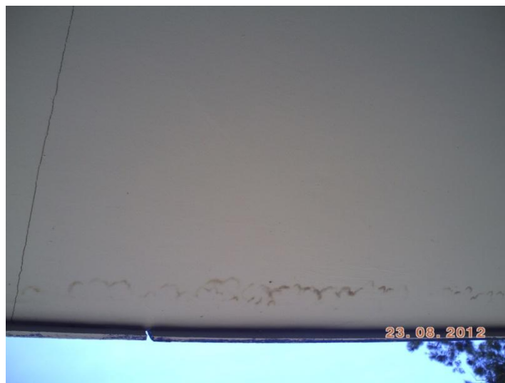
Figura 9. Deterioro por humedad Fachada frontal.
