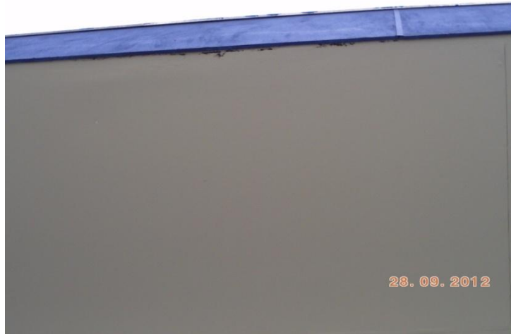
Figura 4. Deterioro por humedad Fachada frontal.
