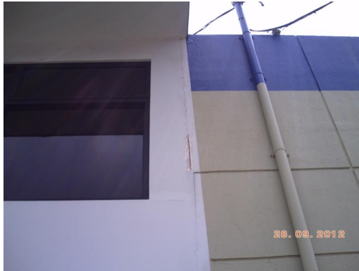
Figura 6. Junta entre pared de Gypsum y pared en concreto.
