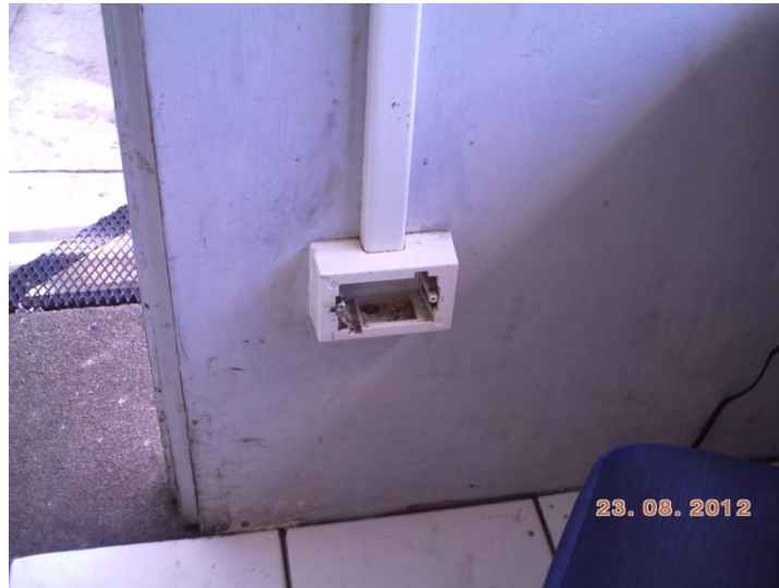
Figura 12. Tomacorriente en mal estado.
