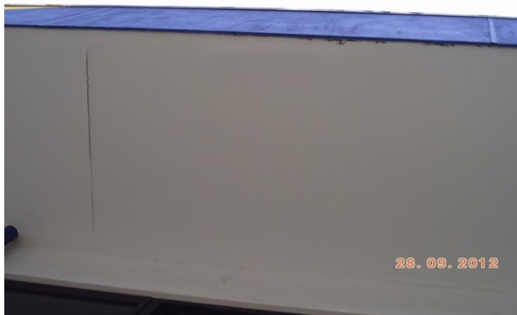
Figura 5. Deterioro por humedad Fachada frontal.
