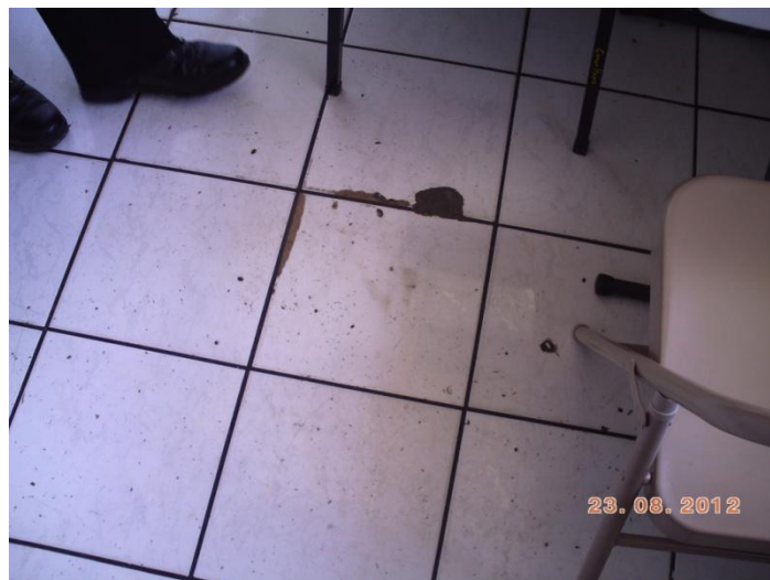
Figura 15. Deterioro de la cerámica (Caseta Guardas).
