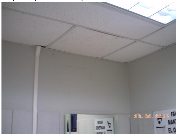
Figura 7. Láminas sucias y desacomodadas.
