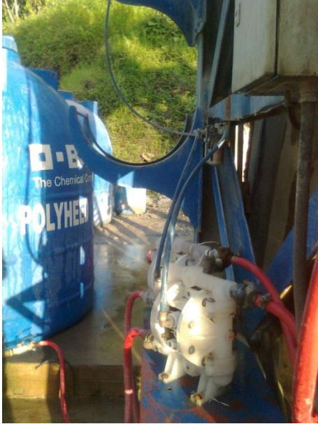
Figura 12. Depósitos y trasiego de aditivo, planta Pozzuolli P.H.R.
