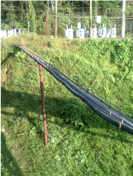
Figura 9. Tubería de abastecimiento de agua, planta Pozzuolli P.H.R.
