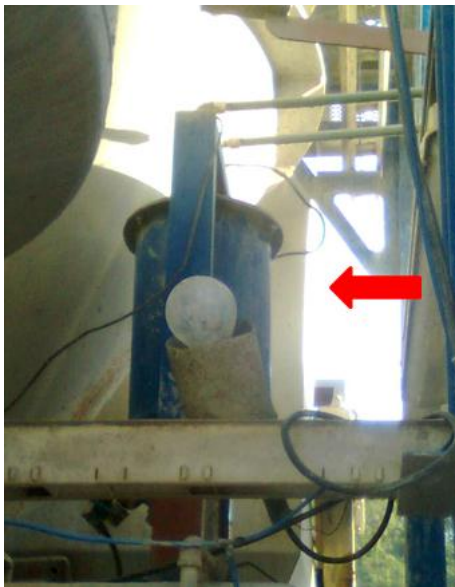
Figura 13. Tanque de almacenamiento de aditivo, planta Pozzuolli P.H.R.
