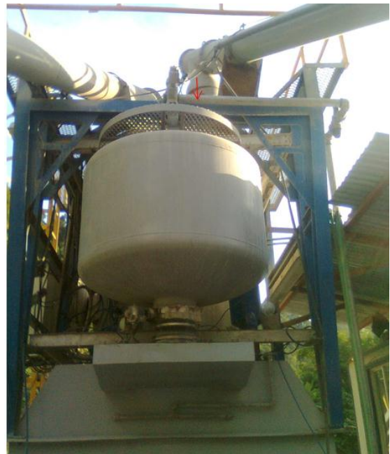
Figura 11. Tanque de almacenamiento de cemento, planta Pozzuolli P.H.R.
